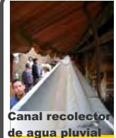
Canal recolector de agua pluvial
