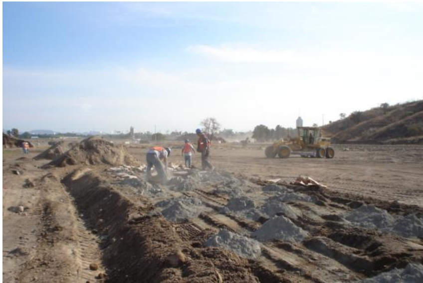
Figura III.33 Colocación del material producto de excavación y cemento para realizar relleno mejorado
