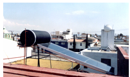
Figura 45 Colector plano para calentamiento de agua
