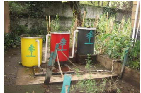
Figura 62 Filtros para limpiar la lluvia. Negro grava 2'', rojo grava pequeña, y amarillo arena. Pasan a la cisterna ubicada debajo.
