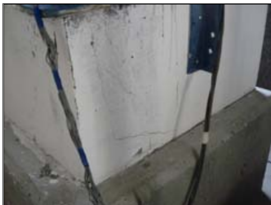
Fig. I.19 Agrietamientos en la base del espécimen
