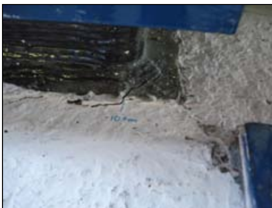
Fig. I.18 Agrietamientos en la unión del espécimen y la base
