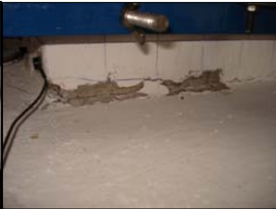
Fig. 1.5 Aplastamiento del concreto en la base del espécimen
