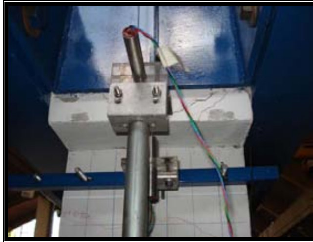
Fig. 4.2.1 Daños en el cabezal debidos a la placa de sujeción y confinamiento
