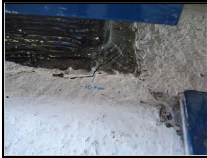
Fig. 5.3.3 Deterioro de las zonas adyacentes al puntal FG en el espécimen ER1
