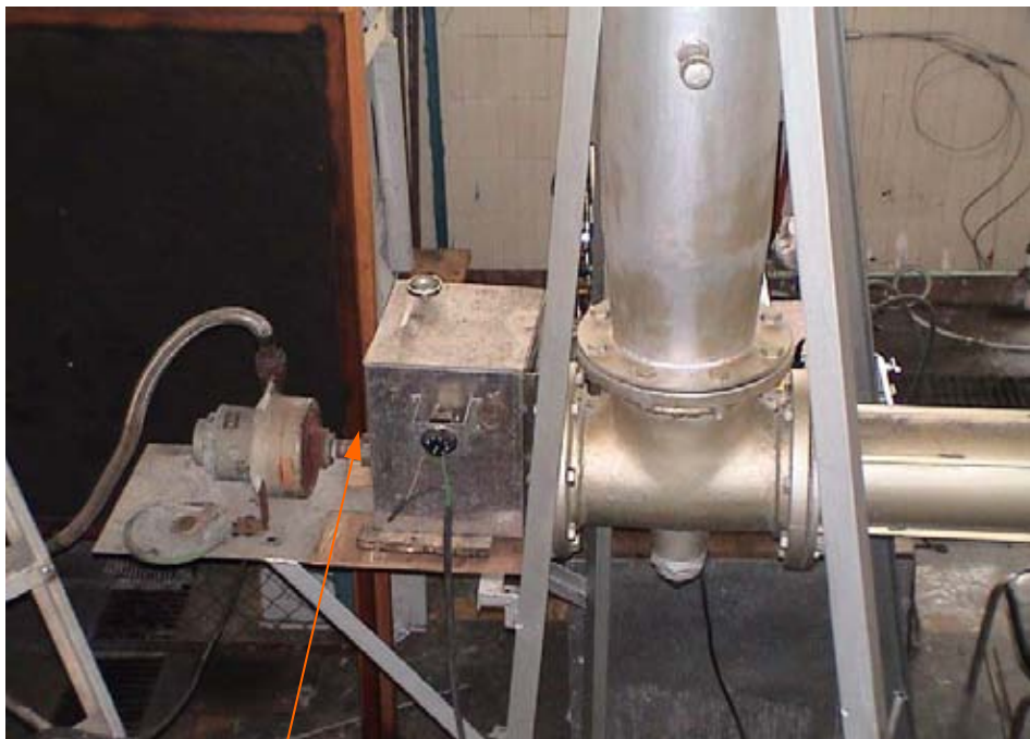
Figura 3.5. Sistema de extracción de partículas/ceniza en chimenea de donde se toman las muestras de gases de combustión
