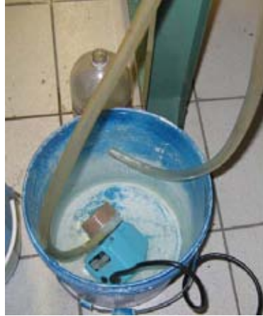
Fotografía 9.- Bomba de abastecimiento de agua
