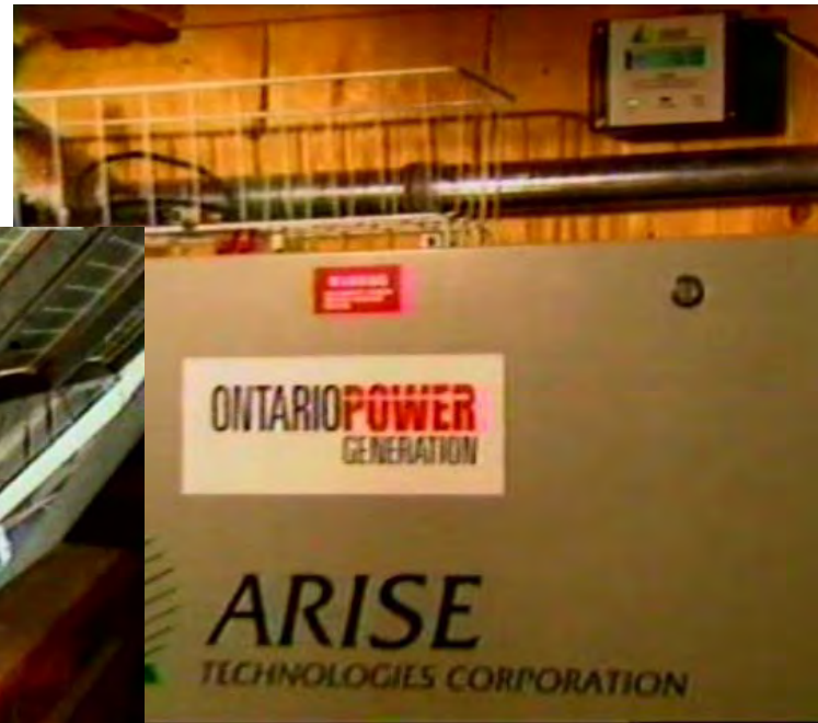
Distribuidor de carga
