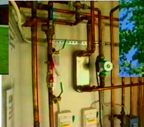
Red hidráulica de calefacción
