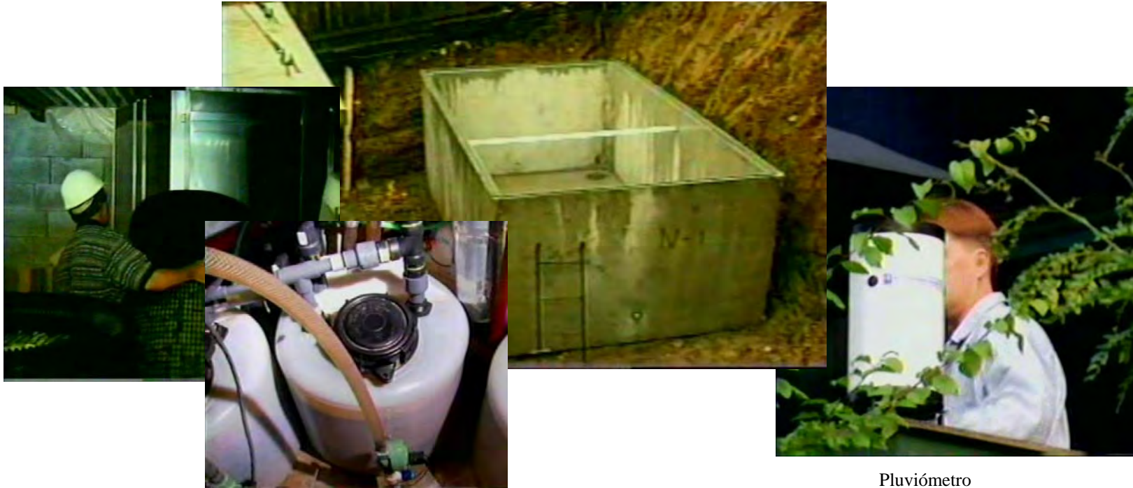
Sistemas de Reciclaje de Agua, que incorporan, filtros de Arena, carbón activado y ultravioleta.
