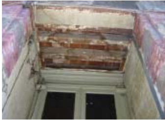
Oxidación de par galvánico en acero de soporte
