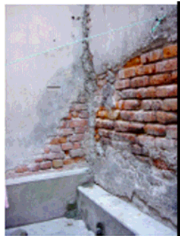
Desprendimiento de material
