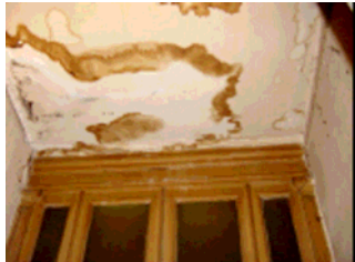
Humedad por Condensación
