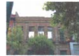
Solo queda la fachada
