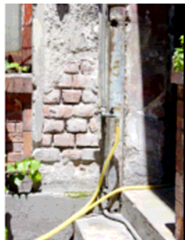
Oxidación en bajada y toma de agua
