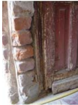
Desprendimiento de material
