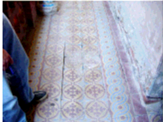
Desgaste en piso de pasillo
