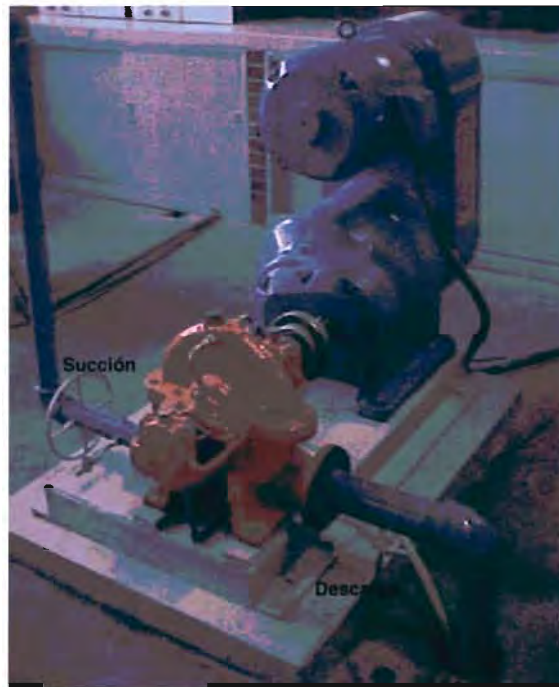
Figura 4.1. Instalación de la bomba de flujo radial. Rango de operación de 1440 a 3280 rpm, potencia 15 HP.
