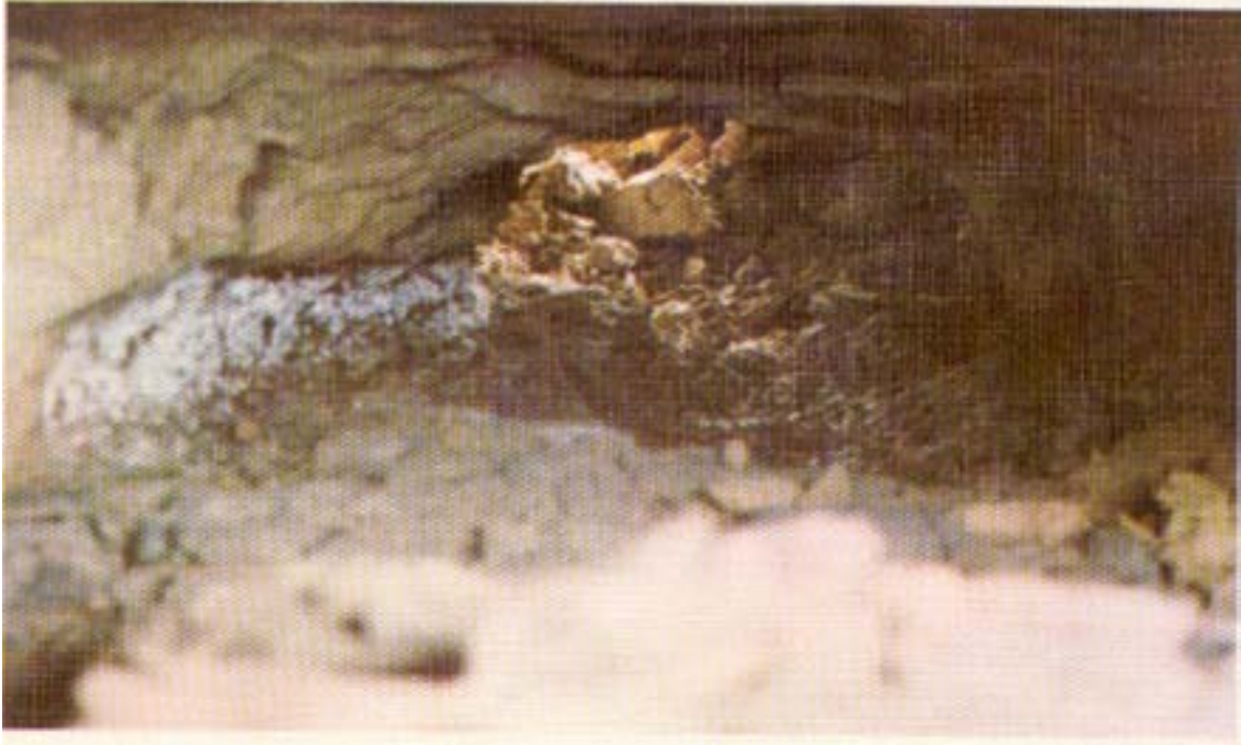
Fotografías 2.7.1 y 2.7.2. Fenómeno de dispersión y tubificación de una obra de contención construida con arcillas dispersivas en el sitio denominado “El Sauz”, estado de Tamaulipas.
