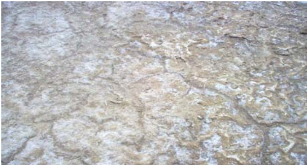
Fotografía 7.1.4. Material arcilloso de origen aluvial, el cual muestra salitre en su superficie, su color es café claro, de espesor variable y se localizó frente al terraplén de la presa de tierra.
