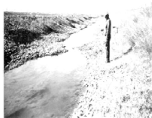
Fotografía 3.2.1 Muestra dispersión de arcillas en el talud de un canal.
