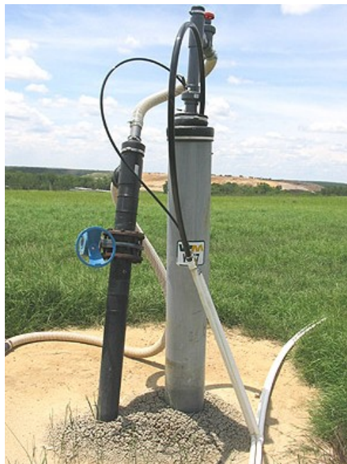
Figura 11. Pozo vertical de extracción con su respectiva bomba (Autopumps ® )
