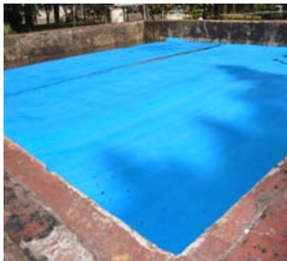
Figura 4-14. Digestor UASB con la cubierta aislante (polifom)
