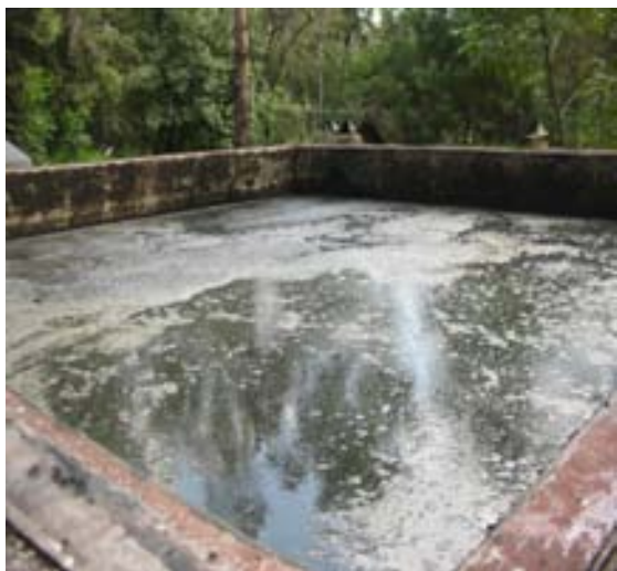
Figura 4-13. Digestor UASB sin la cubierta aislante
