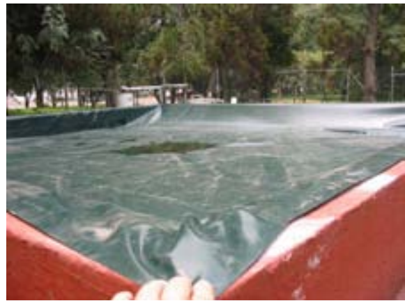
Figura 4-4. Lona de PVC. Cubierta del digestor
