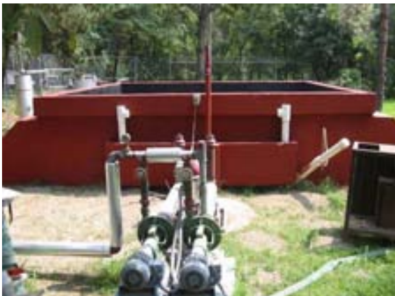
Figura 4-3. Digestor anaerobio. Vista frontal.
