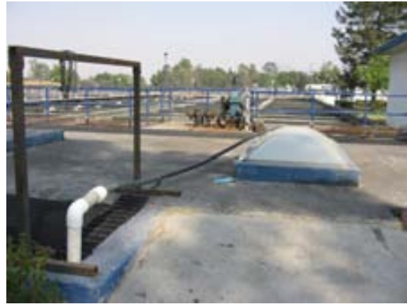
Figura 4-6. Registro de lodos primarios. Línea de conducción de lodo primario.
