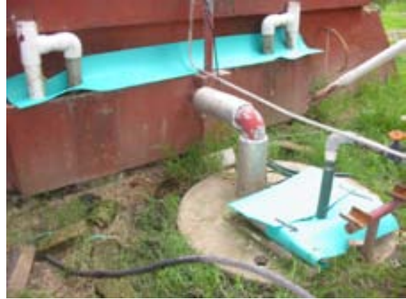
Figura 4-8. Canaleta de recolección de sobrenadante y cárcamo de recirculación de sobrenadante.
