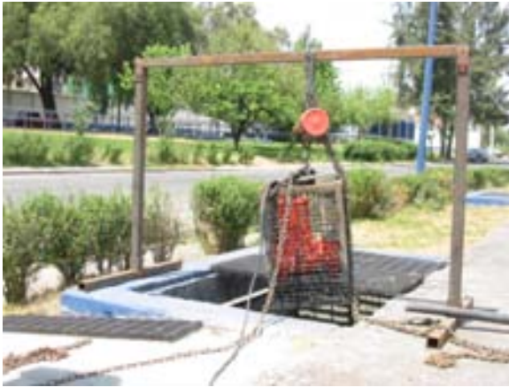
Figura 4-5. Bomba de extracción de lodo. Registro de lodos primarios
