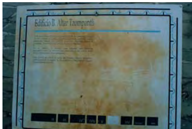
Cédulas visiblemente afectadas, al estar en contacto con la lluvia se oxidaron.
