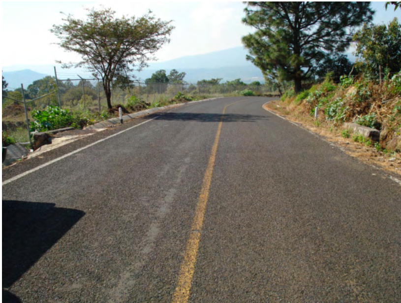
Fotografía en el km 0+280
