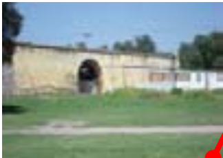
Fig. 42 Se puede ver la fachada poniente de la casa de servidumbre y su deterioro.
