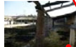
Fig. 40-41 Se puede ver el gran deterioro de las caballerizas con un bebedero de concreto al centro de un patio interior.
