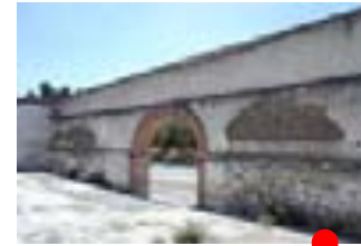
Fig. 39 Es la fachada oriente de las caballerizas y su deterioro
