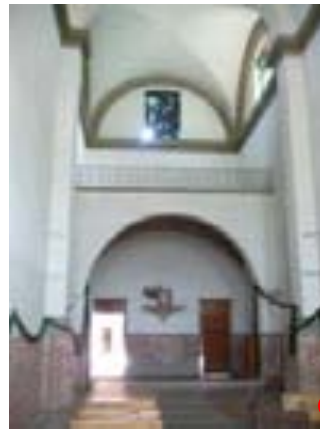
Fig. 33 En la fotografía observamos el soto coro, y a un costado la sacristía de la hacienda de San Antonio
