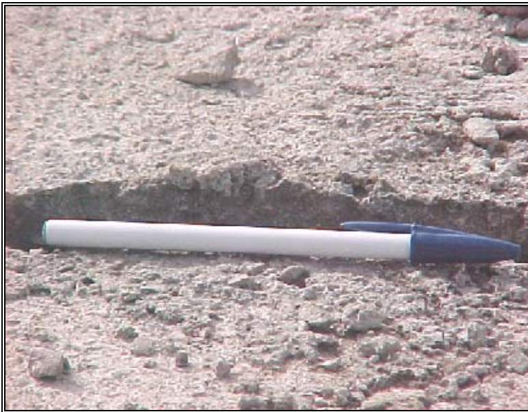
Fotografía IV.12. En la fotografía se muestra el desnivel que existe en la losa de concreto colocada en la plataforma 396, en la zona de la grieta.
