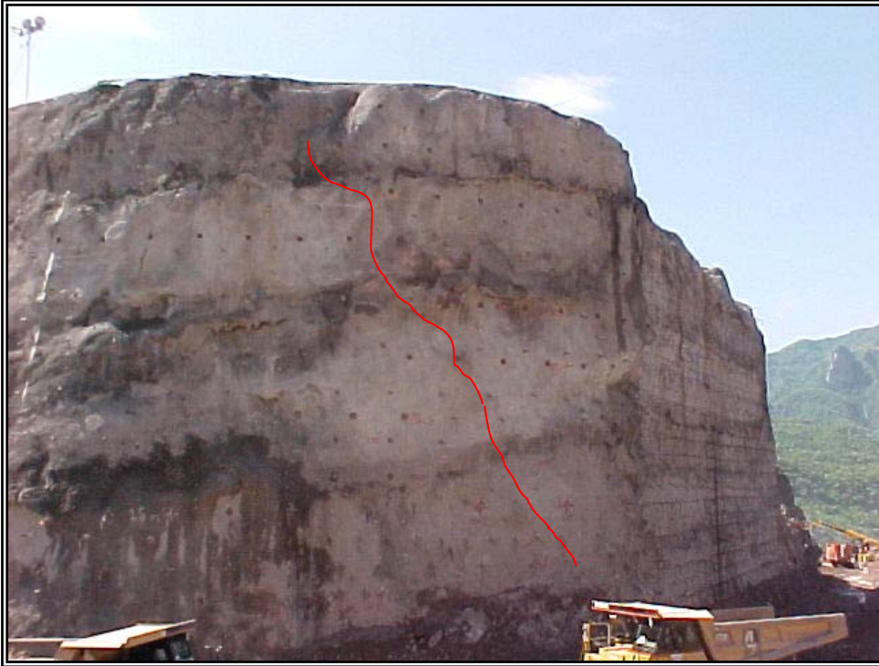
Fotografía IV.8. La presente muestra una grieta en el concreto lanzado en la zona detectada con movimiento por la instrumentación del sitio.
