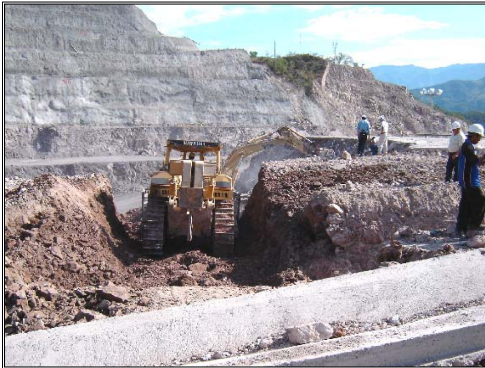
Fotografía V.14. Vista de la remoción del material de falla, obsérvese el contacto con la roca de buena calidad
