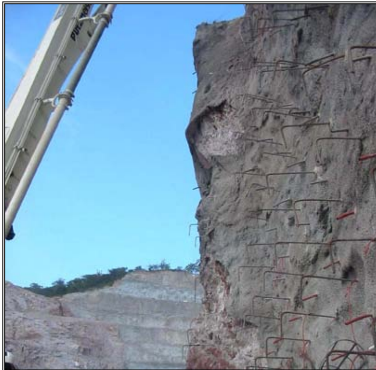
Fotografía IV.9. Zona del muro alabeado con relajamiento reciente, donde existieron desprendimientos del concreto lanzado (cad. 0-015).
