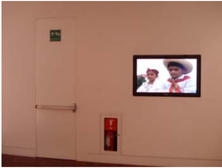
44. Deficiencia en acabados e instalaciones
