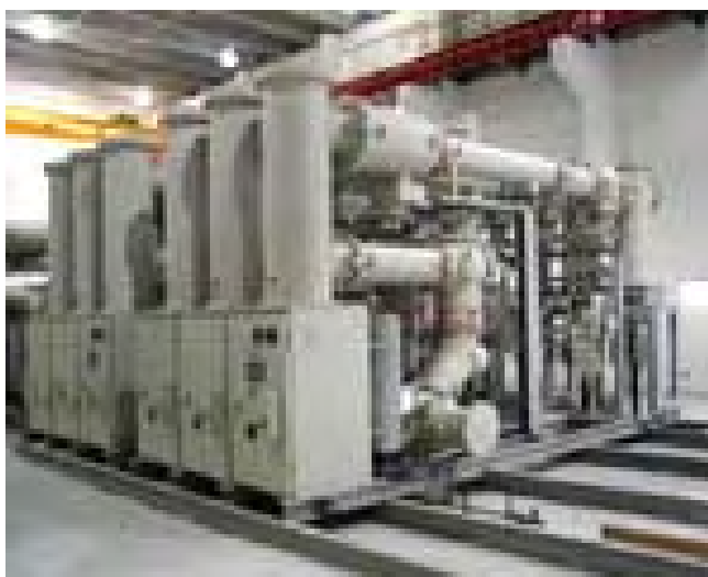
Figura 6.4 Subestación Eléctrica de Alta Tensión (SEAT)
