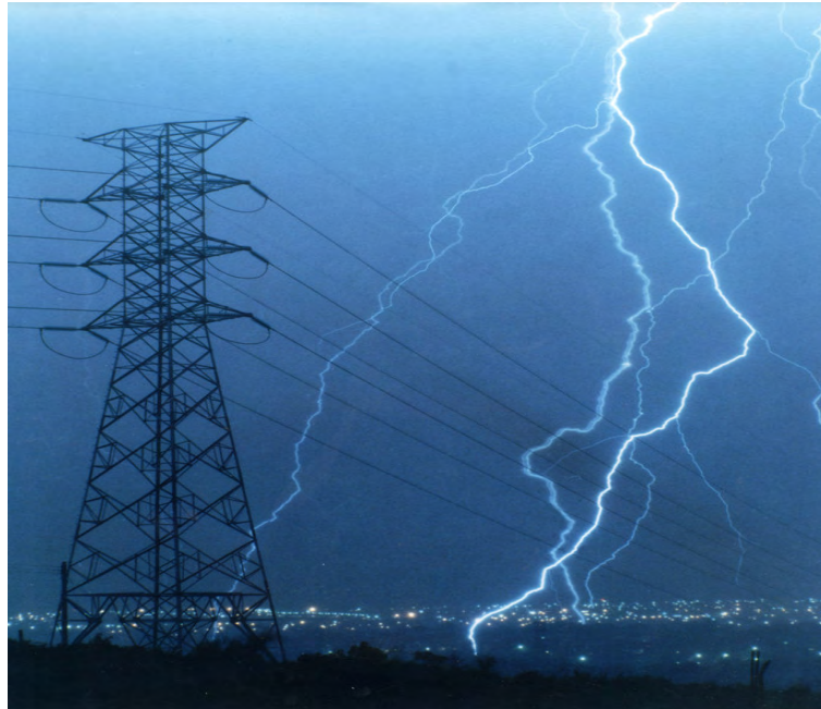
Figura 2.5 Línea de transmisión de energía eléctrica (Fuente CFE)
