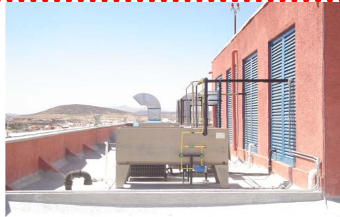
AZOTEA CON EQUIPOS DE AIRE ACONDICIONADO
