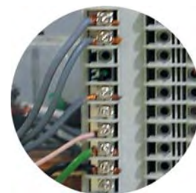
Foto 5. Conexiones del termostato.
