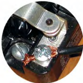
Foto 3. Conexión del contactor.
