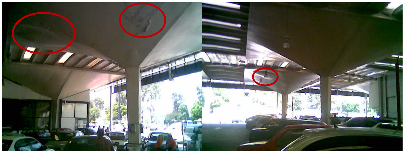
Fig. 135- El principal deterioro, se debe a la falta de mantenimiento, sobre todo en las áreas semi exteriores como el estacionamiento, donde la humedad ha generado estragos en los recubrimientos, sin embargo estas fallas bien localizadas, no representan un peligro inminente para la estructura en general.
