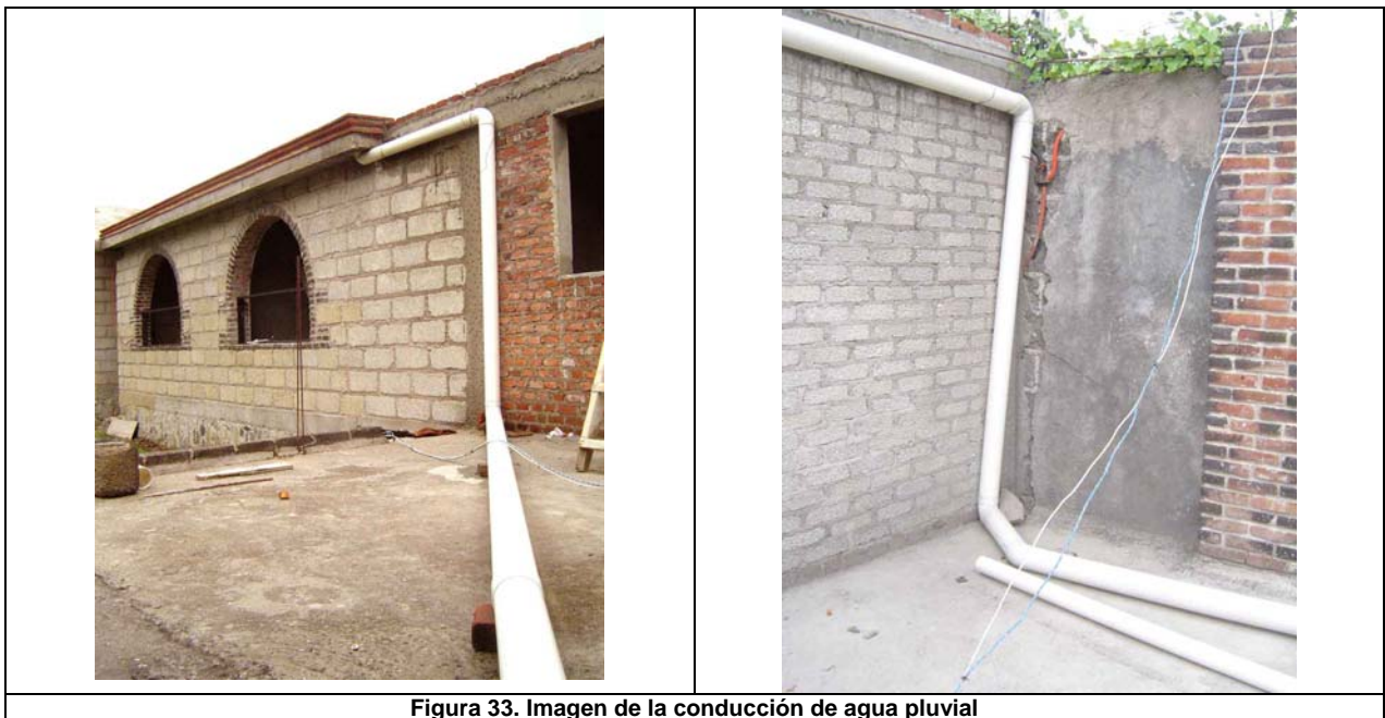
Figura 33. Imagen de la conducción de agua pluvial
