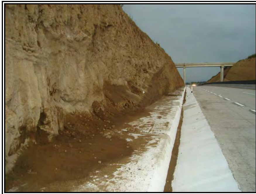
Figura 47. Caído de finos sobre la banqueta
