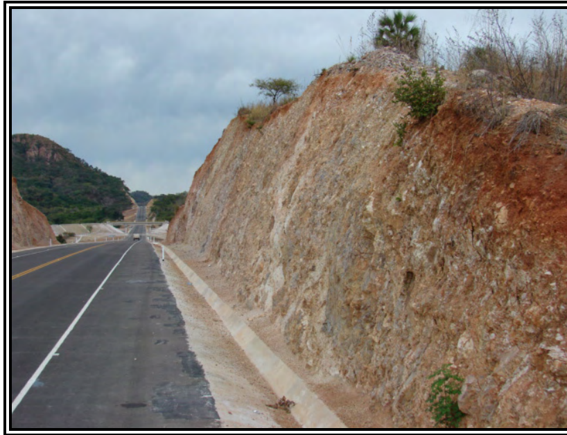
Figura 5. Cuneta al pie del Corte
