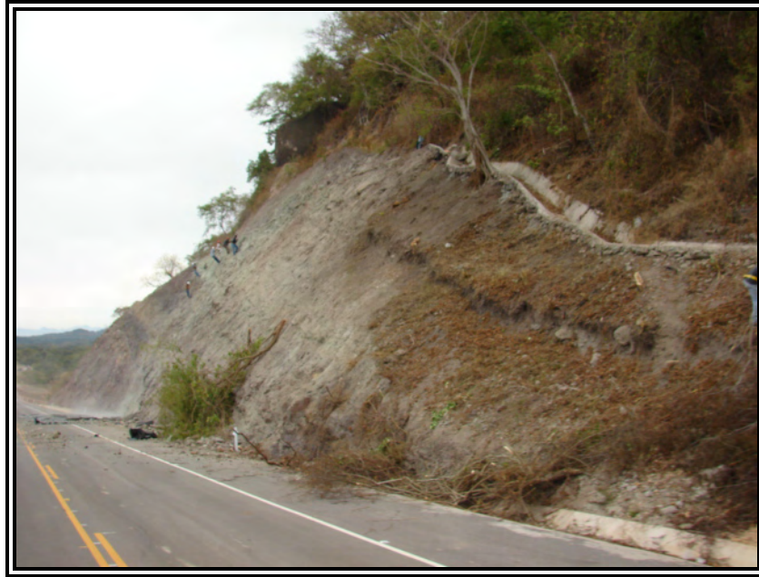
Figura 6. Contracuneta en la parte superior del corte
