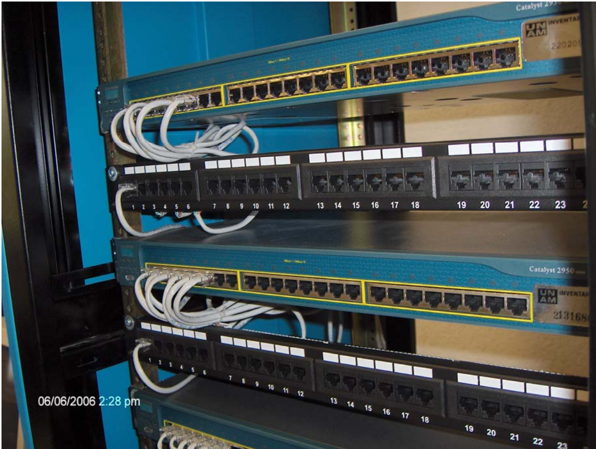
En la imagen 8: dos de los tres Switches Cisco Catalyst 2950 con sus Paneles de Parcheo del Posgrado en Ciencia e Ingeniería de la Computación.
