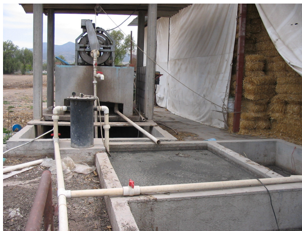
Figura 3. Fosa de sedimentación aeróbica.
