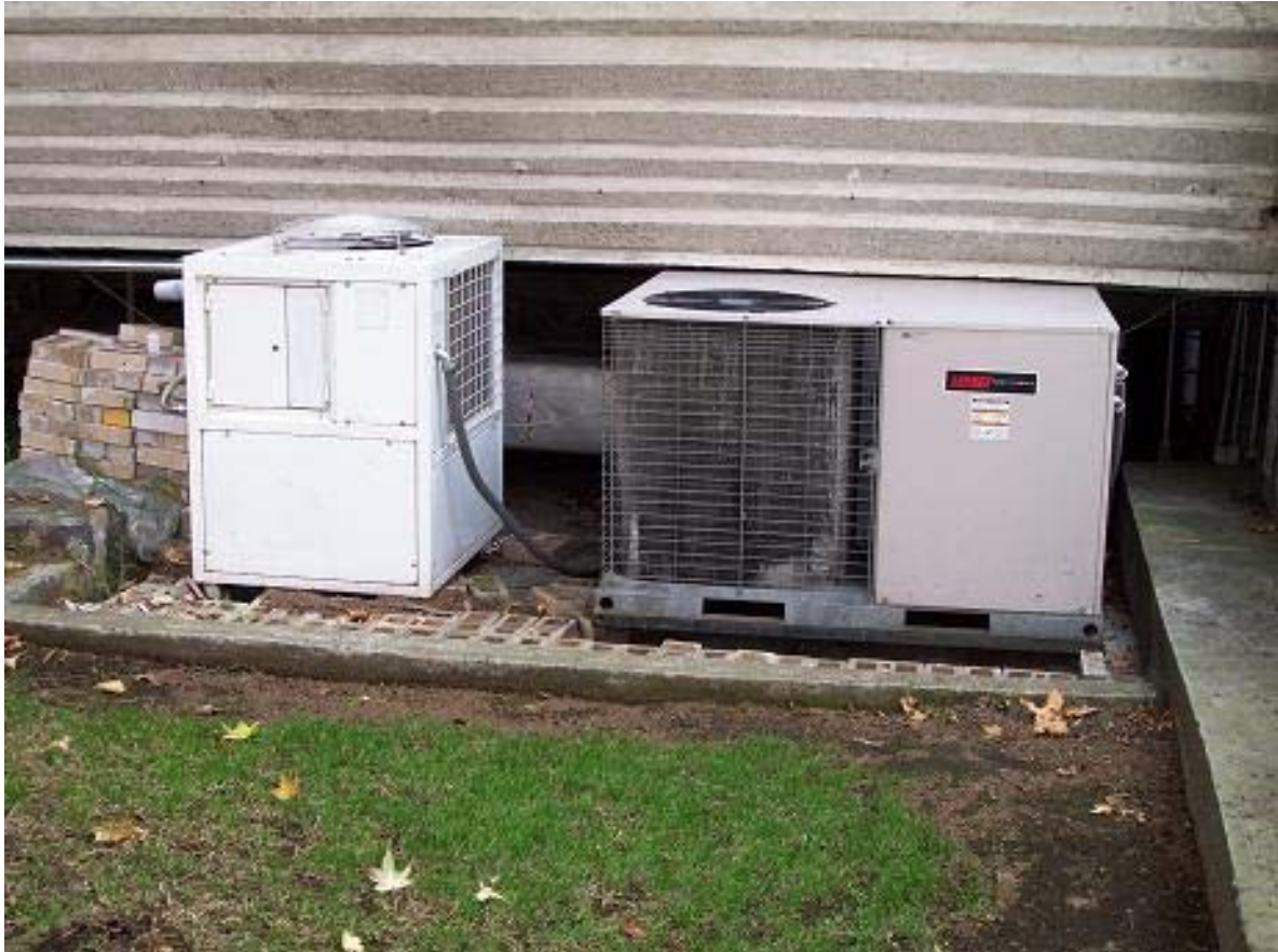
Figura 2.7 Condensador de la unidad Chiller (izquierda). Unidad de paquete para el cuarto de los UPS en el sótano del edificio principal (derecha).
