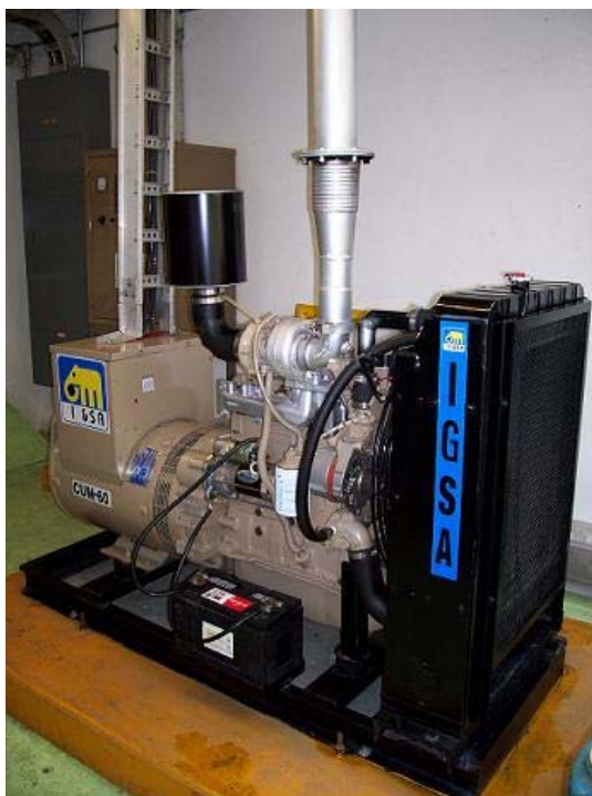
Figura 5.14. Planta de emergencia de 60 kW.
