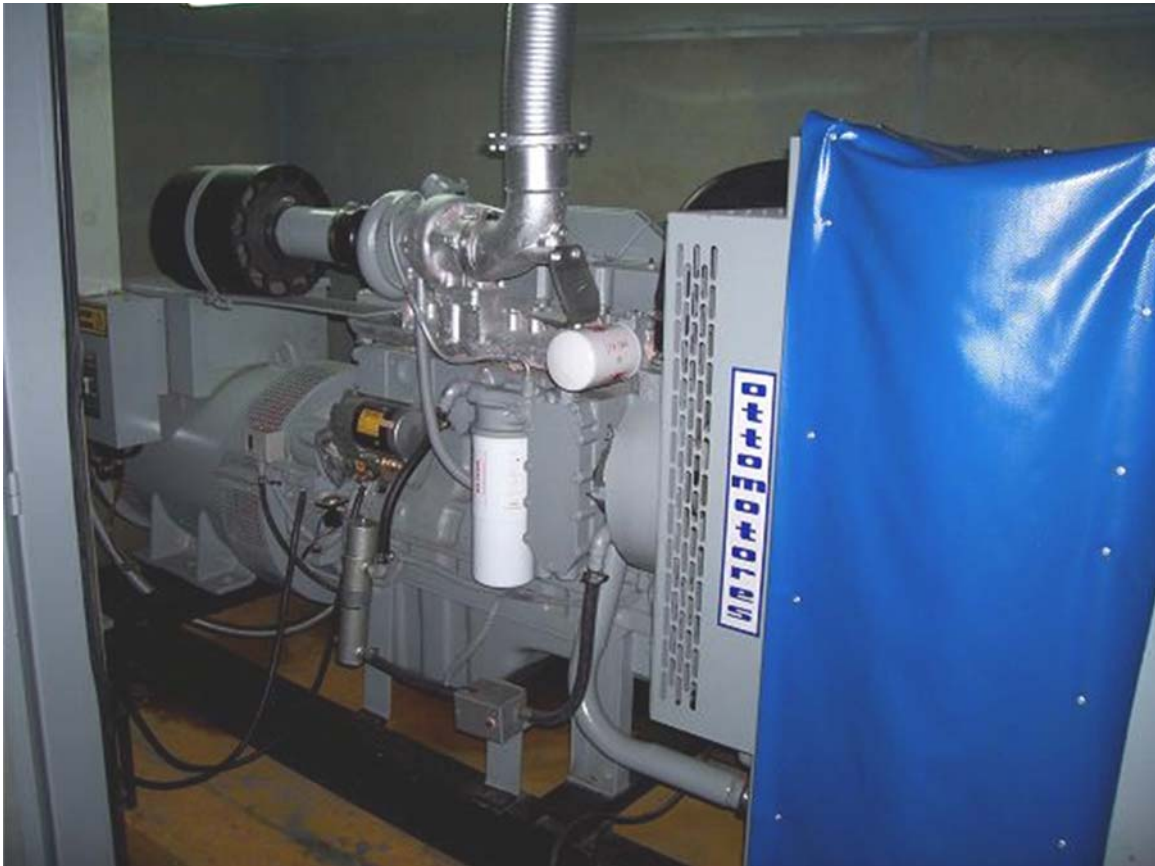
Figura 2.11 Vista general de la planta de emergencia de 150 kW.
