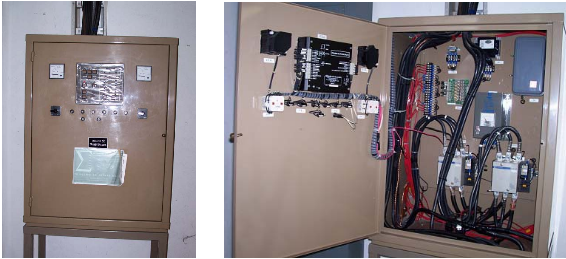
2.16 Tablero de transferencia de la planta de emergencia de 60 kW.
