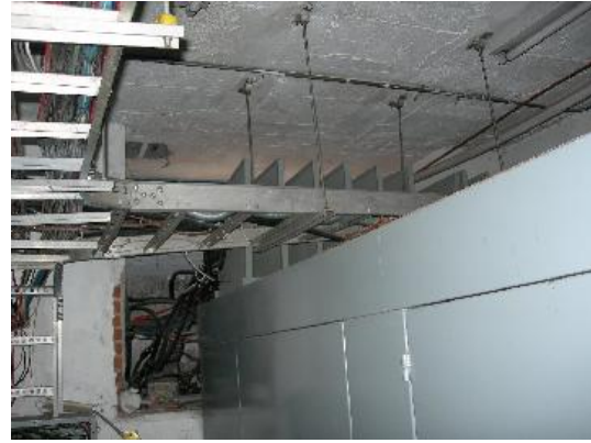
Figura 5.11 Entrada de aire frío
