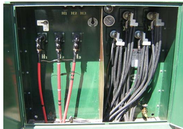
Figura 2.3 Alta y Baja tensión de la subestación
