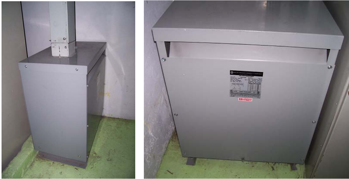
Figura 2.18 Transformadores conectados a UPS de 100 kVA.
