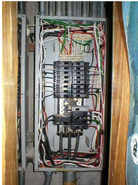
Figura 5.18 Tablero con el color de las fases incorrecto
