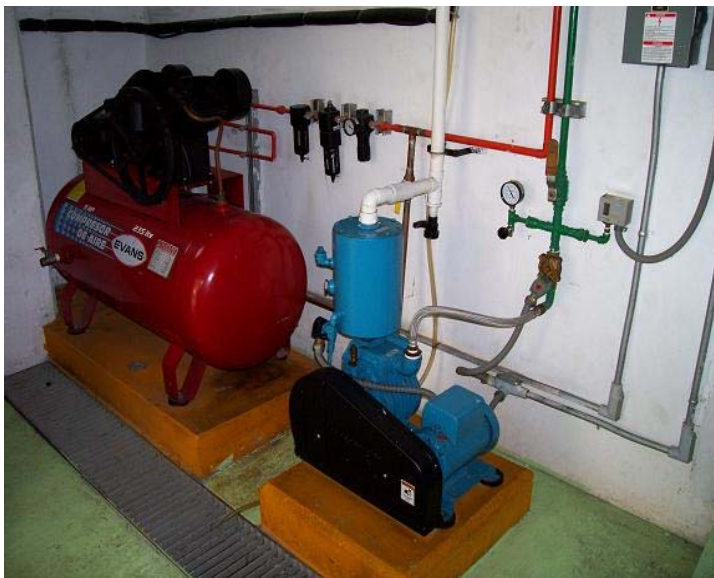
Figura 2.9 Sistema hidroneumático del edificio anexo
