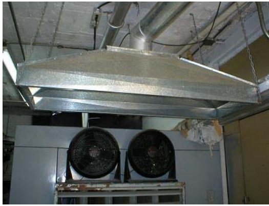
Figura 5.10 Campana de extracción de aire caliente
