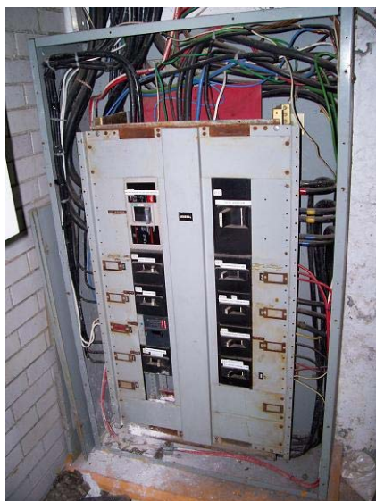
Figura 3.6 Tablero sin tapa del edificio principal.
