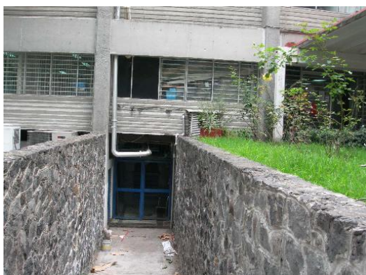
Figura 5.5 Puerta de acceso a planta de emergencia
