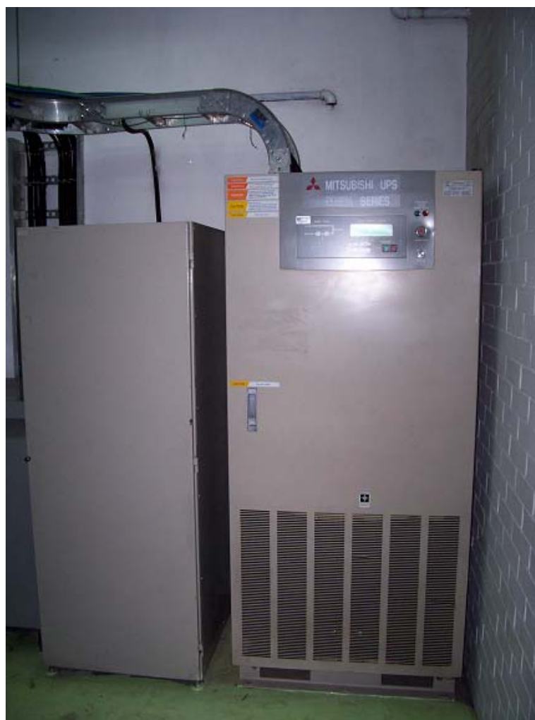
Figura 2.17 UPS de 20 kVA.
