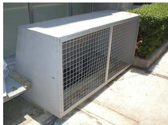
Figura 5.9 Tolva de captación de aire frío
