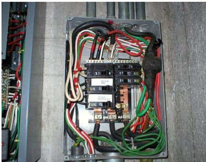
Figura 3.10 Tablero con empalme grueso
