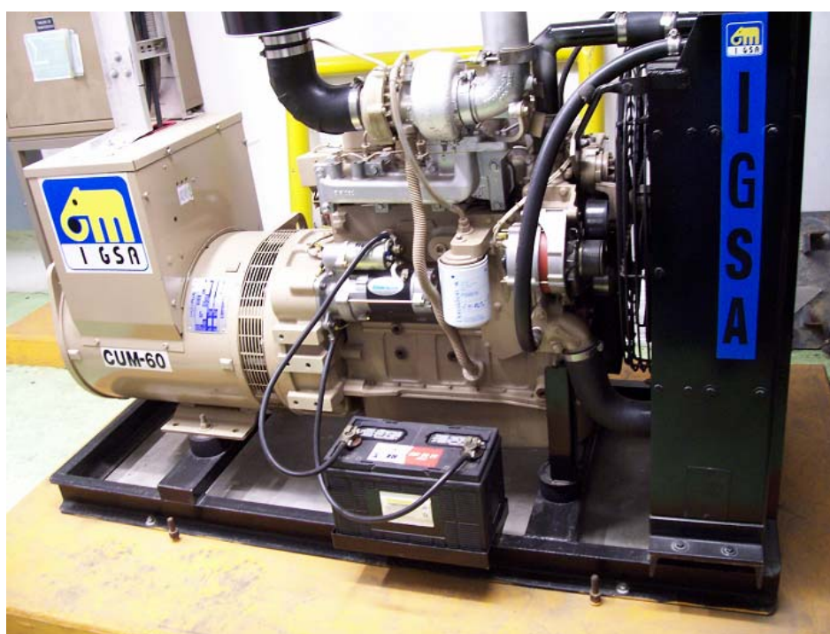
Figura 2.15 Vista del generador de la planta de emergencia de 60 kW.
