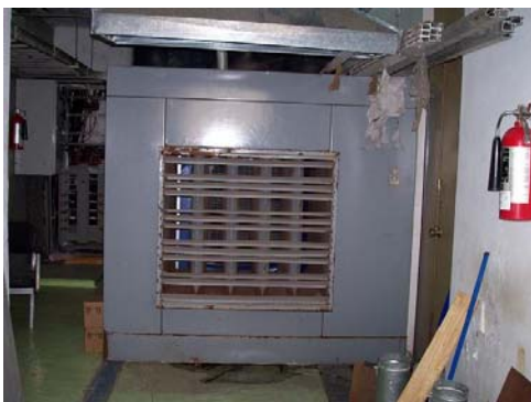
Figura 5.1 Cuarto de máquinas del edificio principal.
