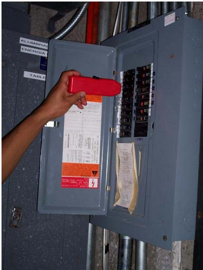
Figura 3.4 identificación de circuitos
