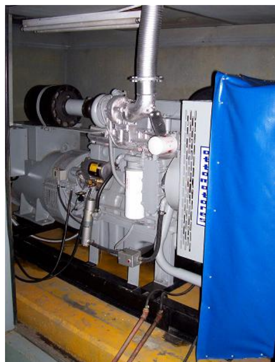
Figura 5.15. Planta de emergencia de 150 kW.
