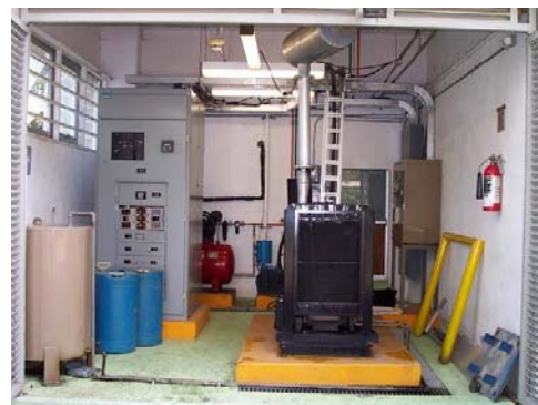
Figura 5.2 Cuarto de máquinas del anexo.
