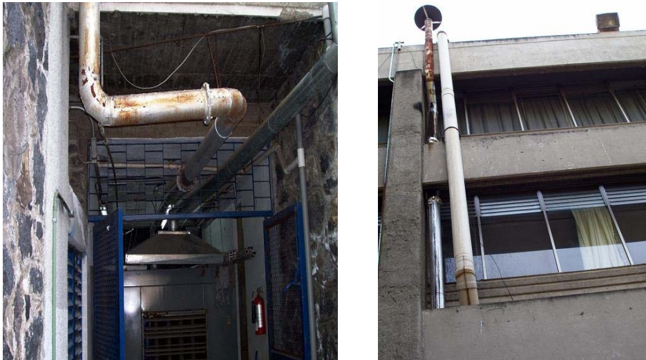
Figura 5.16 Salida del tubo de escape de planta de 150 kW.
