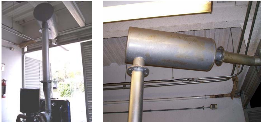
Figura 5.17 Salida del tubo de escape de planta de 60 kW.
