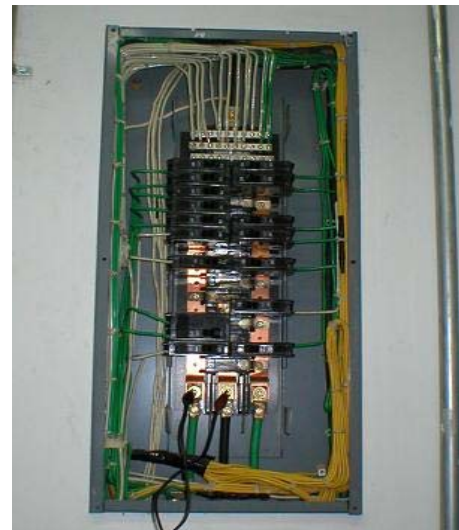
Figura 3.11 Cables sueltos dentro del tablero
