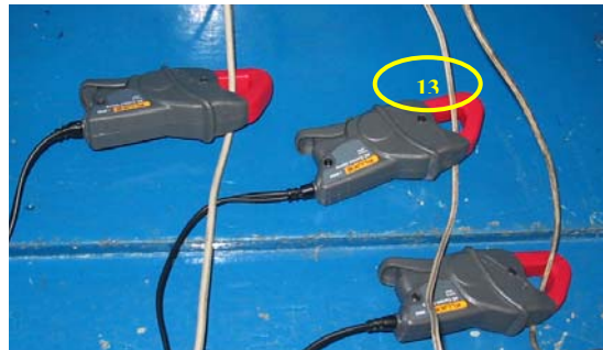
Figura 3.6 Fotografía de las pinzas amperimétricas empleadas en la interfaz de hardware del ACEE
