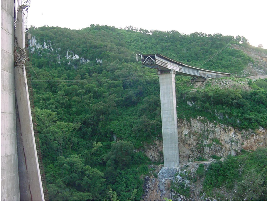
A LA IZQUIERDA, LA PILA DAÑADA A LO LEJOS, EL LADO SAN CRISTÓBAL DEL PUENTE
