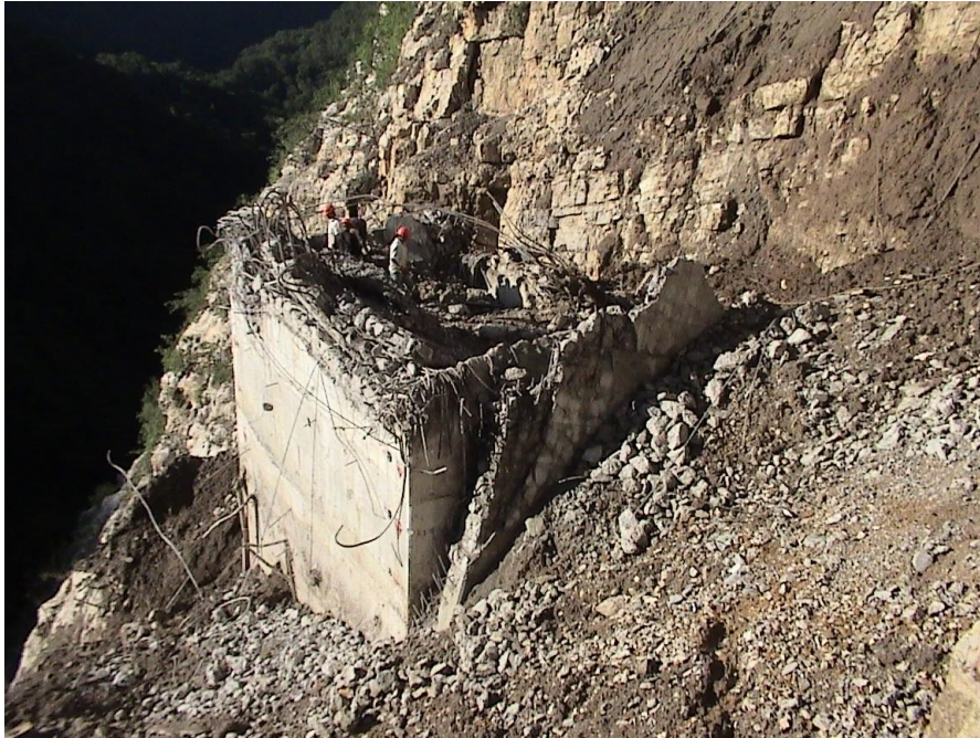
RESTOS DE LA PILA DESPUÉS DE LA EXPLOSIÓN
