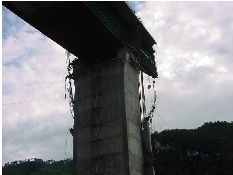
LA PILA DAÑADA DESDE ATRÁS (DESDE SU BASE)
