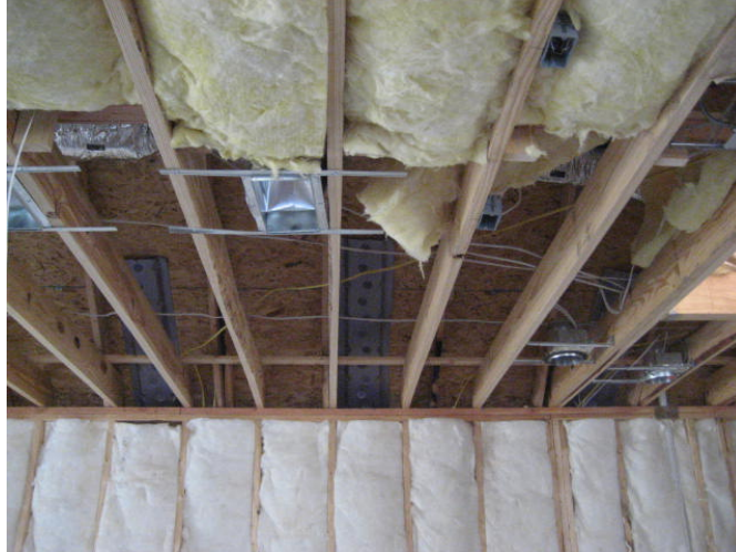
Fig. No. 8. Entre los puntales de 2"x4" y entre las vigas de 2"x 6" se colocan paquetes de fibra de vidrio.
