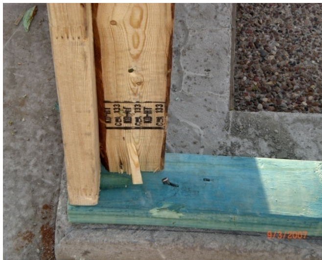
Fig.No. 16. Anclaje de la estructura de madera a la cimentacion por medio de clavos de 4".
