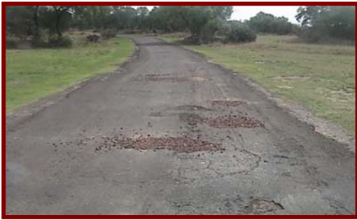
Problemas en el mantenimiento de los pavimentos de la ZAT
