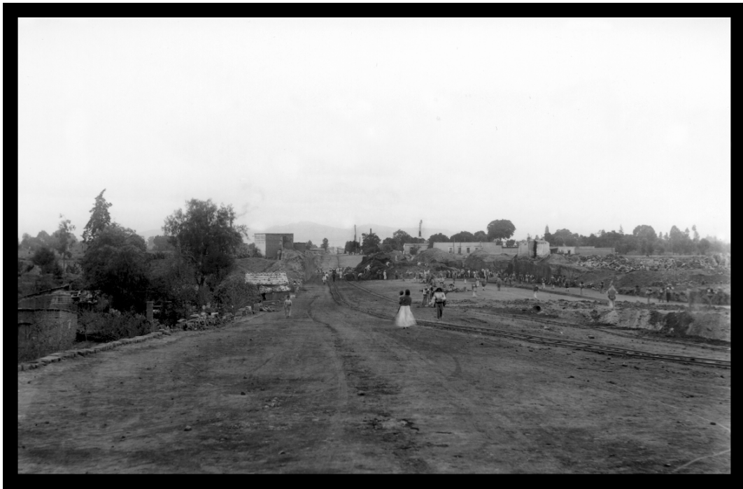
17SCO63. Ignacio Avilez-SCOP, “Construcción de la Avenida de los Insurgentes”, 1921-1924. Tramos a la altura del Rancho San José o Actipan.
