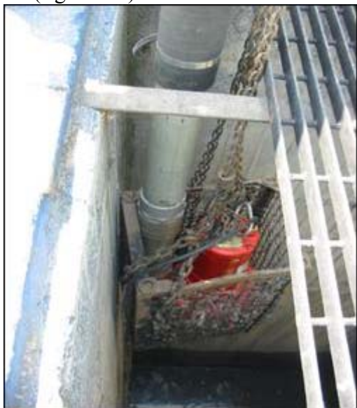
Figura 4.3 Registro de purga y bomba sumergible
