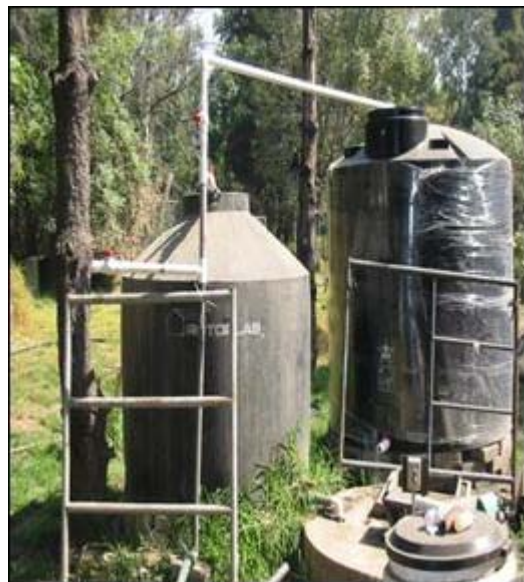
Figura 4.4 Tanques de almacenamiento
