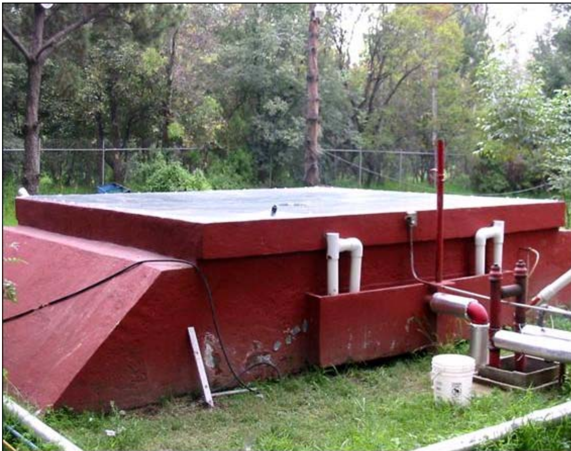
Figura 4.7 Vista del digestor tipo UASB ubicado en PTAR Cerro de la Estrella. Vista de la canaleta de evacuación del sobrenadante.
