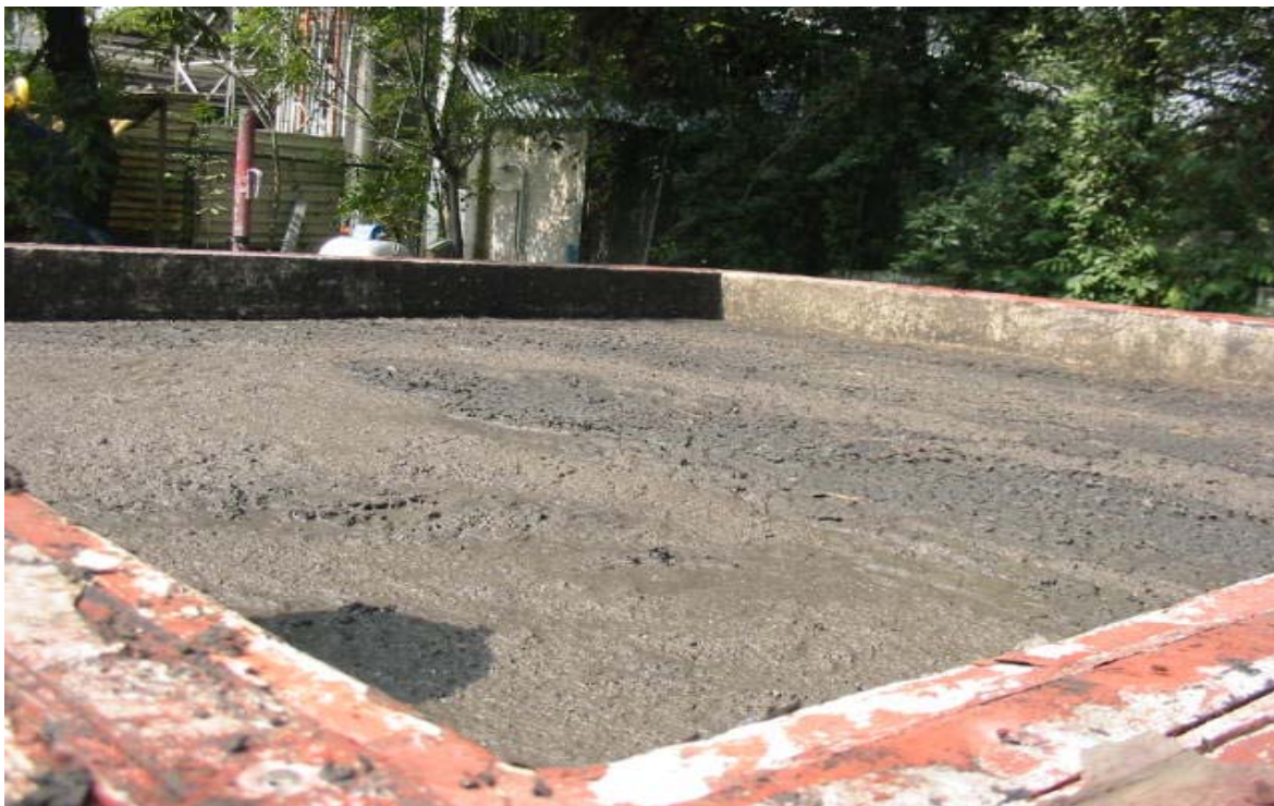
Figura 5.27 Nata de lodo sobre la superficie del digestor UASB
