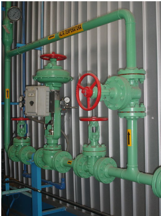
FIGURA 4.1 – VÁLVULA DE CONTROL FLUJO DE AGUA
