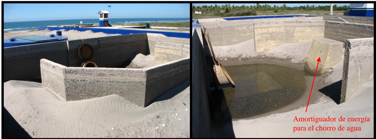
Figura 18. Vistas de la caja de sedimentación.
