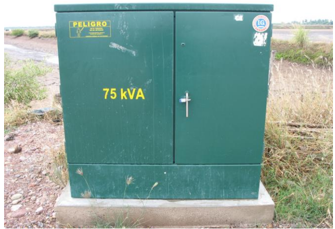
Figura 63. Transformadores de 75kVA.
