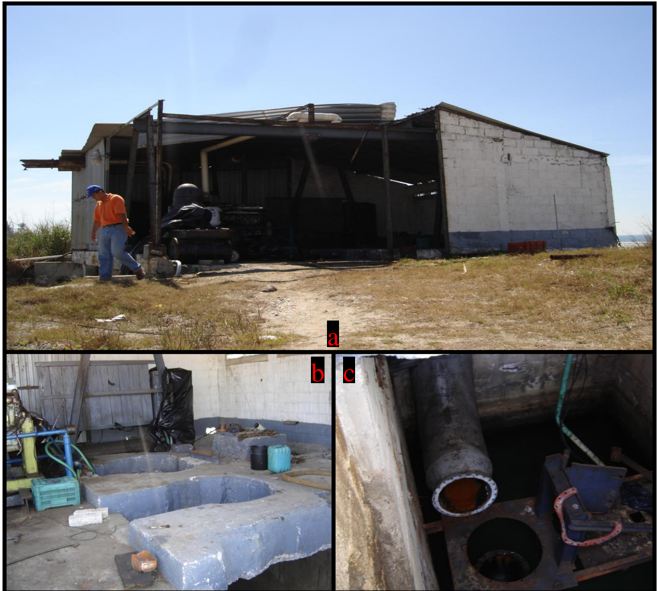
Figura 84. Estación de bombeo: a) vista externa de la estación de bombeo, b) y c) vistas del cárcamo de bombeo.
