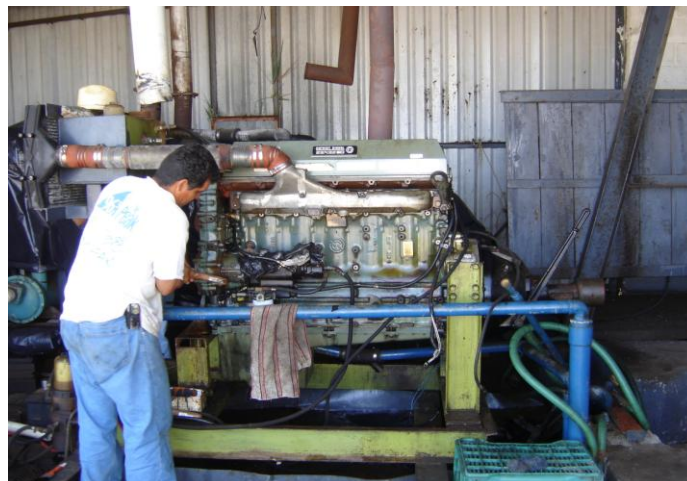
Figura 88. Equipo de bombeo diesel.
