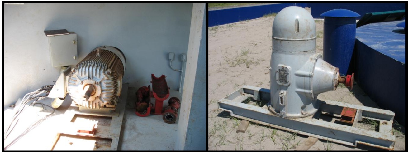
Figura 38. Equipo de bombeo eléctrico.
