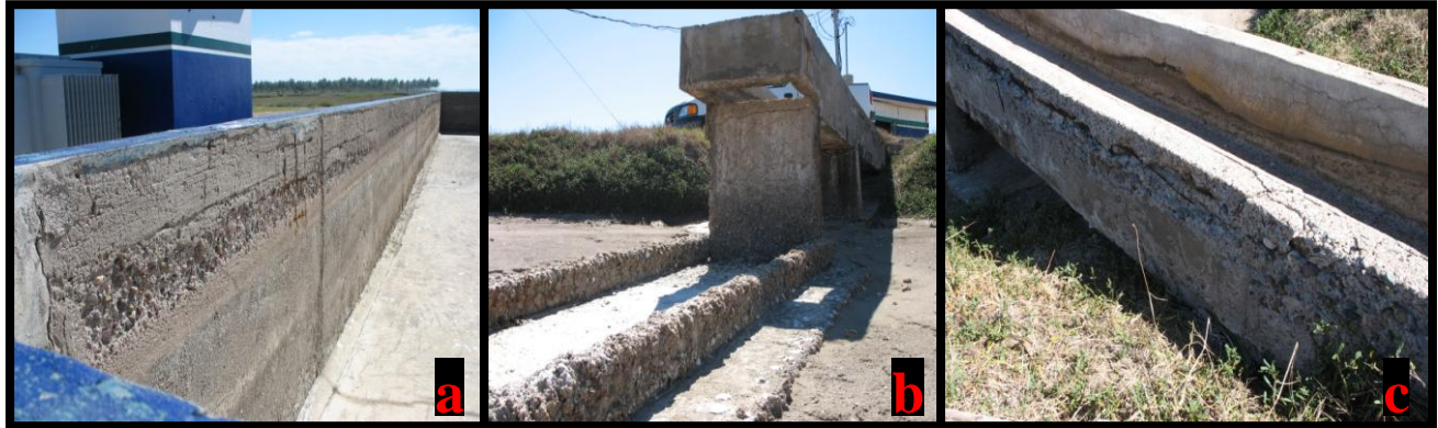
Figura 24. Deterioro en algunas estructuras de concreto para la conducción del agua a los estanques: a) estructuras para el proceso de filtrado, b) y c) estructuras de abastecimiento de agua para los estanques.
