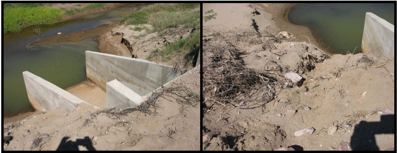
Figura 27. Deterioro en bordería adyacente a las estructuras de salida.
