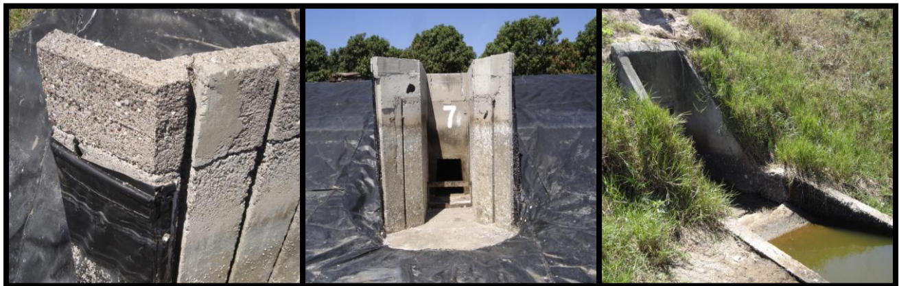
Figura 82. Deterioro en estructuras de salida.
