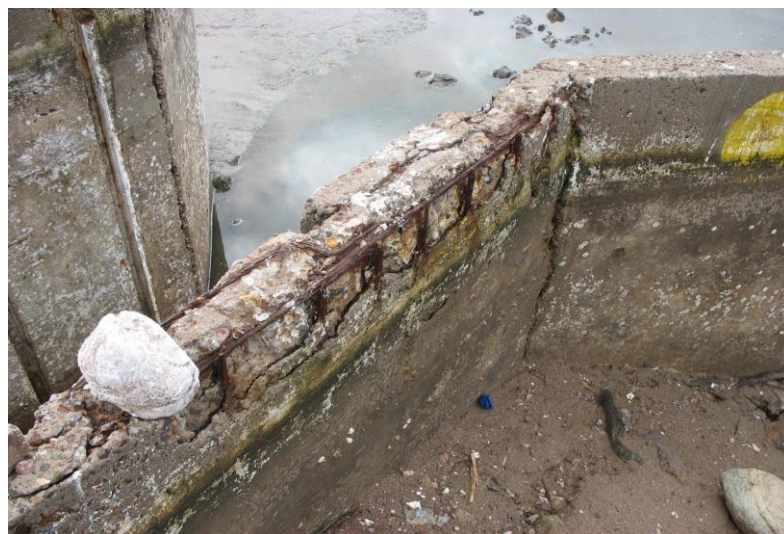
Figura 51. Deterioro de estructuras de abastecimiento de agua.
