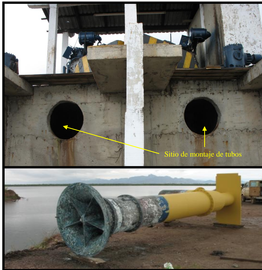
Figura 61. Detalle de sitio de montaje de los tubos y vista de un tubo succionador.
