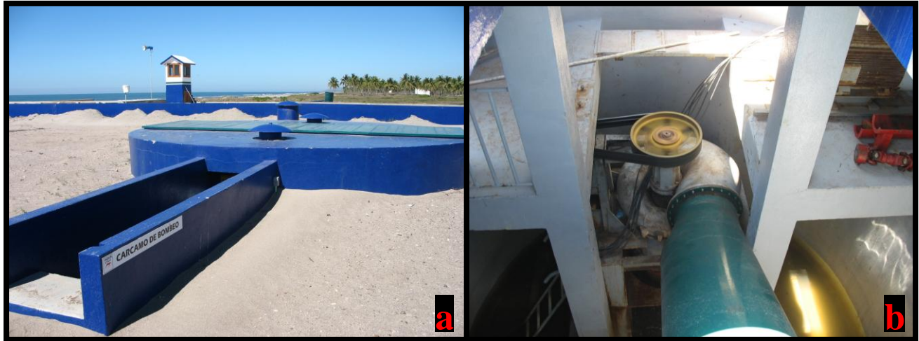
Figura 33. Estación de bombeo: a) vista externa de la estación de bombeo y b) vista del cárcamo de bombeo.
