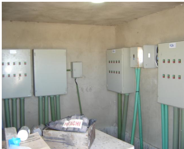
Figura 90. Tableros de control.
