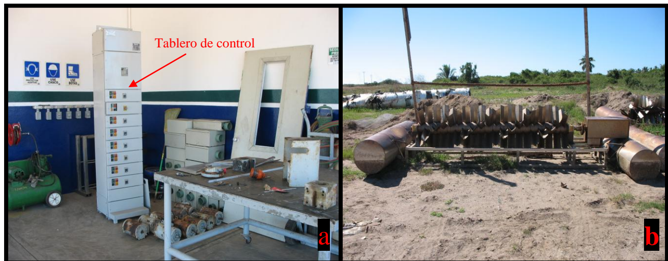
Figura 40. Equipamiento para la operación: a) tablero de control para aireadores, b) aireador del tipo helicoidal.
