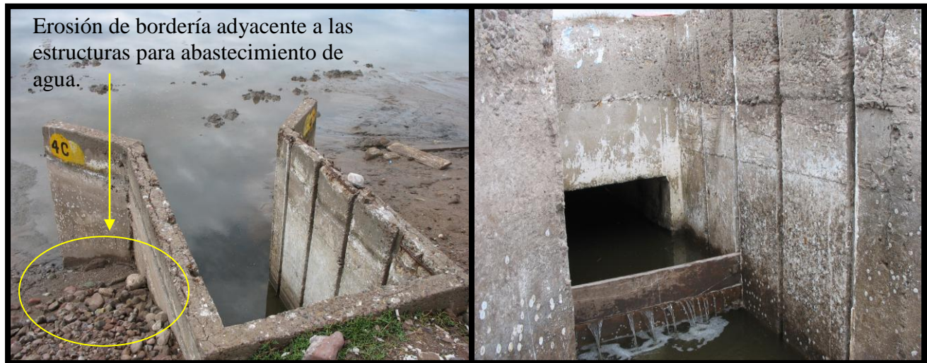
Figura 50. Estructuras para abastecimiento de agua.
