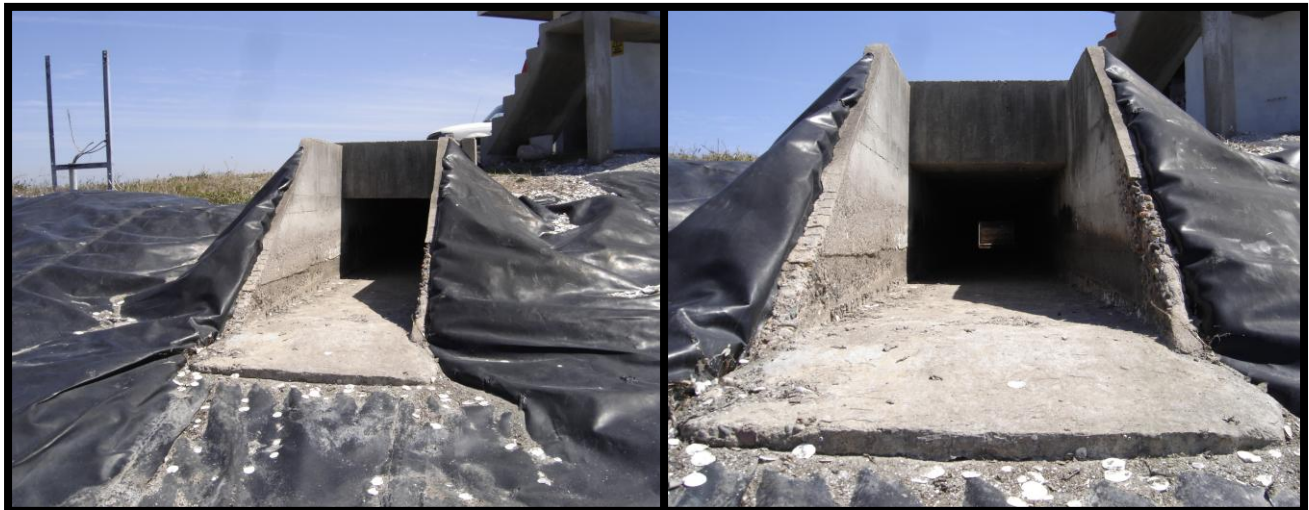
Figura 78. Vista de una estructura de alimentación para los estanques.
