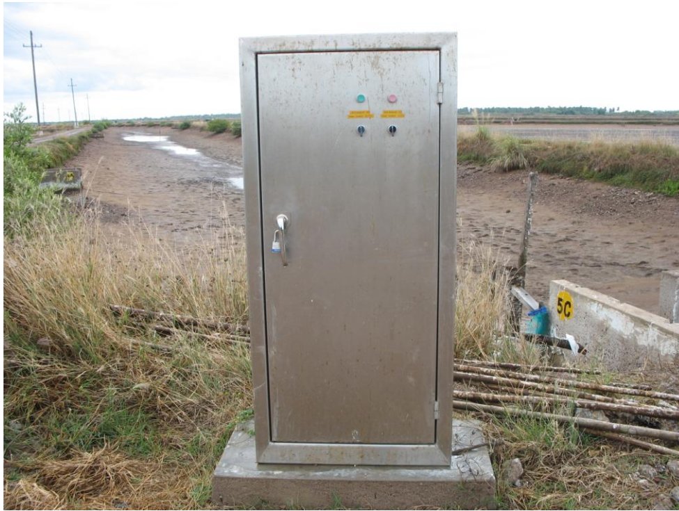
Figura 66. Tableros de control para los aireadores.
