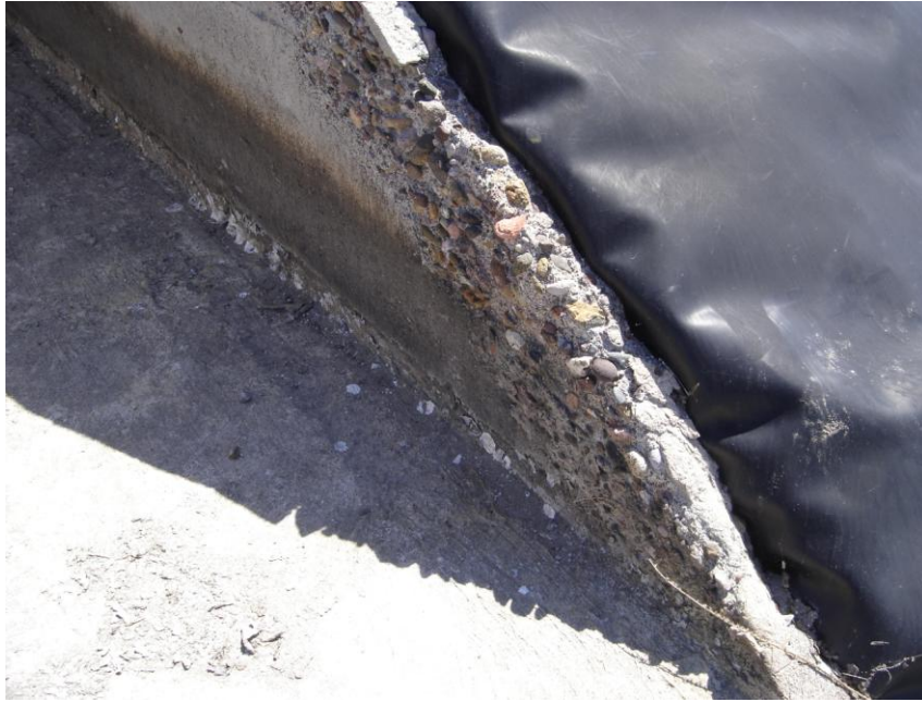
Figura 79. Deterioro en alguna de las estructuras de concreto para la conducción del agua a los estanques.
