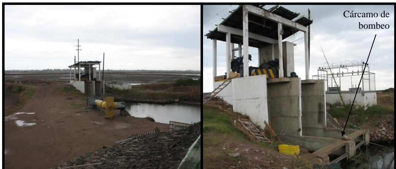
Figura 56. Estación de bombeo.
