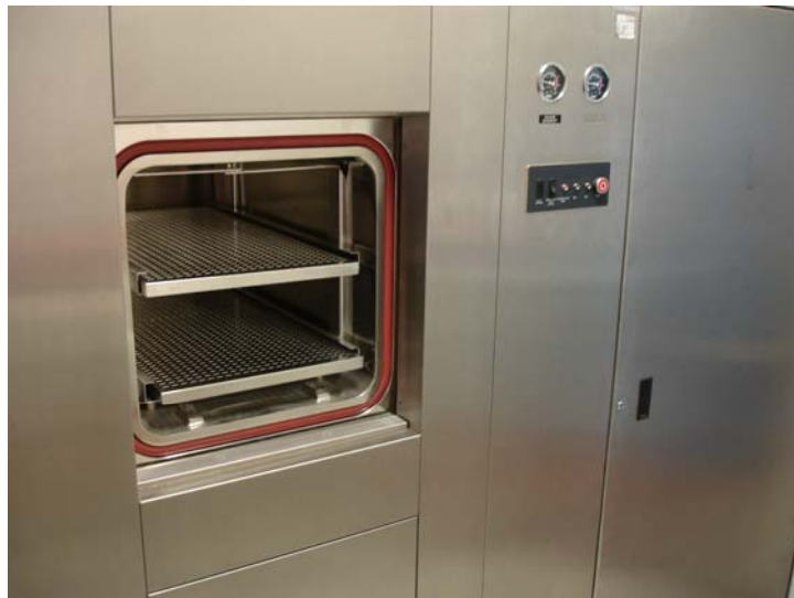
Fotografía 20. Autoclave de doble puerta, BSL3.
