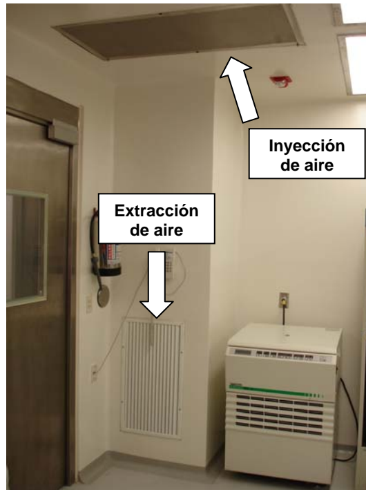
Fotografía 21. Rejillas de inyección y extracción de aire. Conductos independientes.
