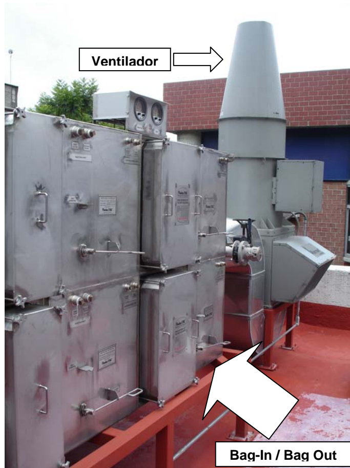
Fotografía 23. Sistema de extracción, contención de filtros HEPA Bag-In / Bag Out, BSL3.
