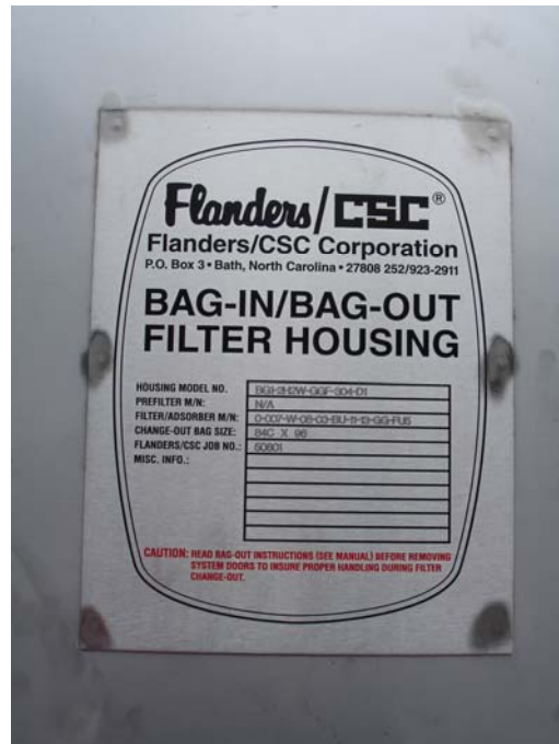
Fotografía 24. Sistema de extracción, contención de filtros HEPA Bag-In / Bag Out, BSL3.
