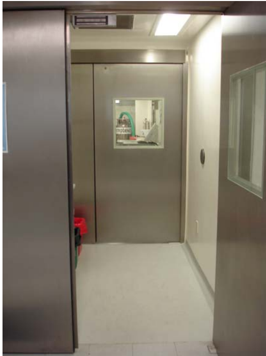
Fotografía 1. Sistema de puertas automáticas
