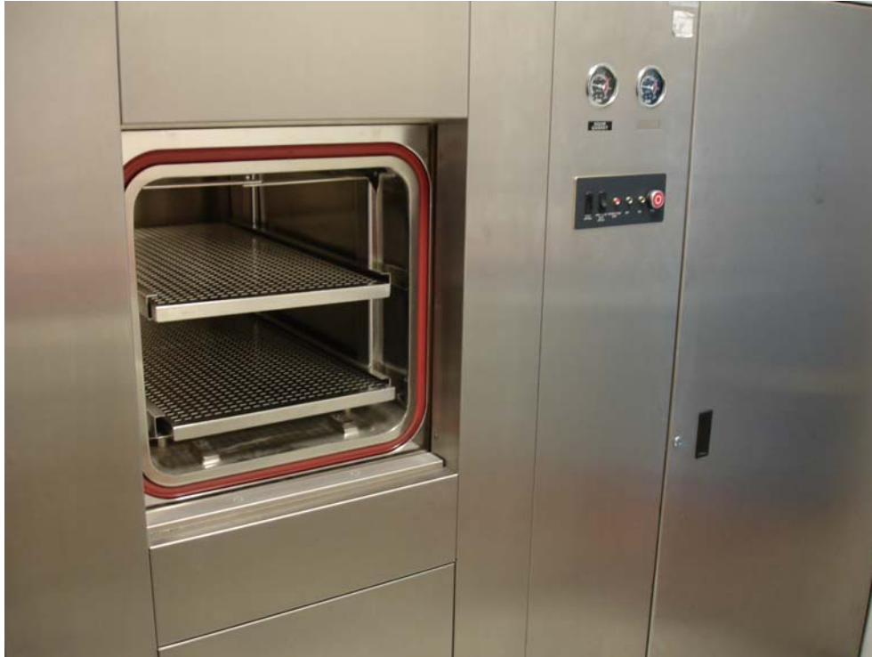
Fotografía 8. Descontaminación. Autoclave de doble puerta.
