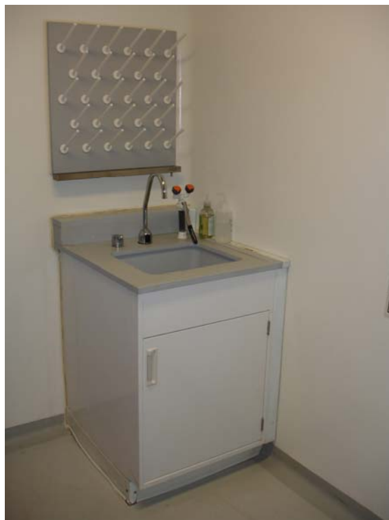
Fotografía 3. Tarjas con sensor de presencia.
