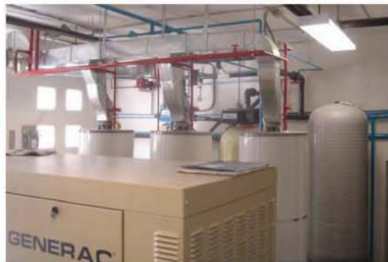
FOTO 26. CUARTO DE MAQUINAS.
