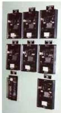
Figura 10. Panel de Protección con relevadores electromecánicos.
