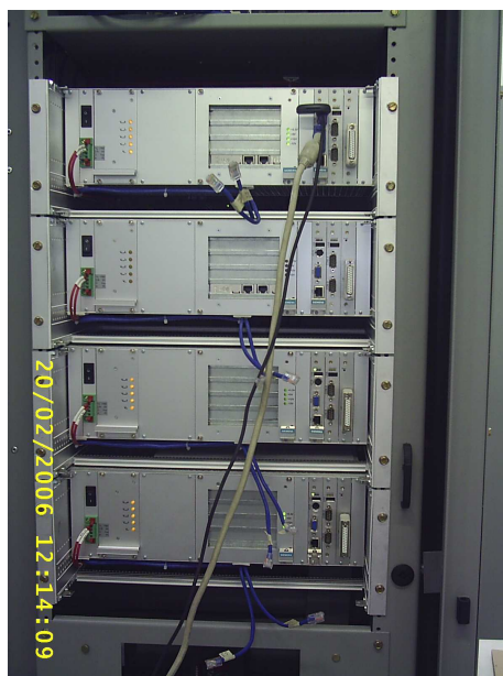
. 11.2 Servidor SCADA (SICAM PAS )
