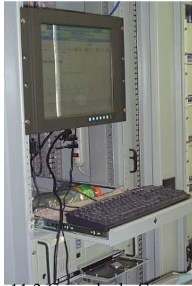
11.3 Consola de Control Local
