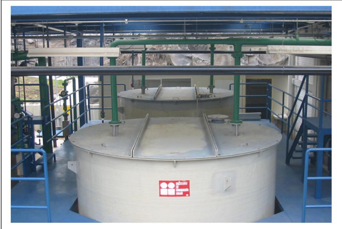
Figura 3-3. Sistema de biofiltración de gases, Ciudad Universitaria, México..
