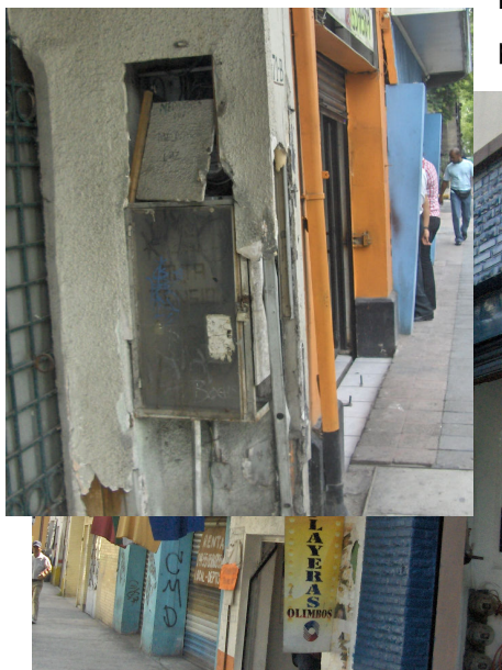
Inmueble de los años 30, con desprendimientos en la fachada. Colonia Algarín, Ciudad de México, 2007.
