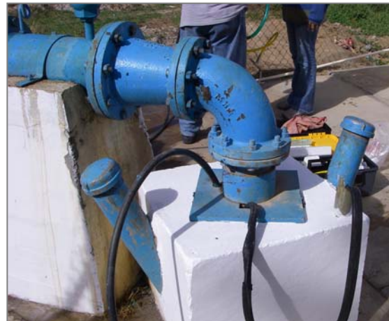
Foto No. 1.3. Pozo en San Damian Texoloc
