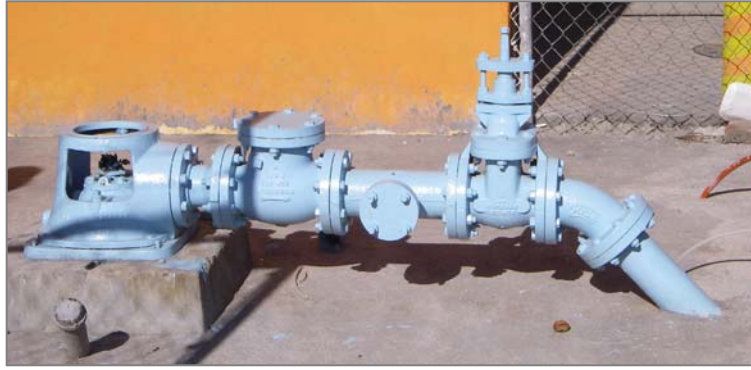
Foto No. 1.1. Pozo de abastecimiento, San Mateo Ayecac, Edo. de Puebla; se aprecia que no cuenta con medidores de flujo ni tubería de salida para tomar muestras de agua
