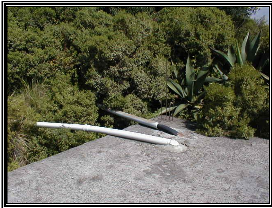
Figura 4.7 Tubería de conducción (Marquesa- San Juan Yautepec) en tanque de almacenamiento actual.
