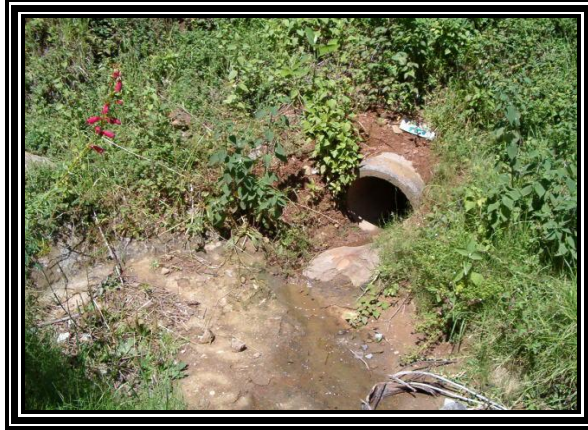
Figura 2.27 descargas de aguas residuales y efluentes
