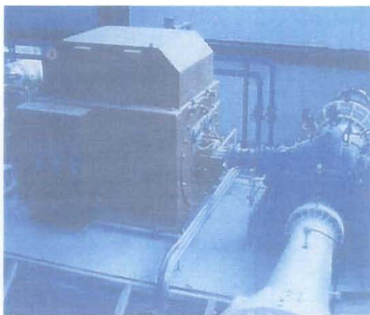
Equipo de bombeo PB. 6
