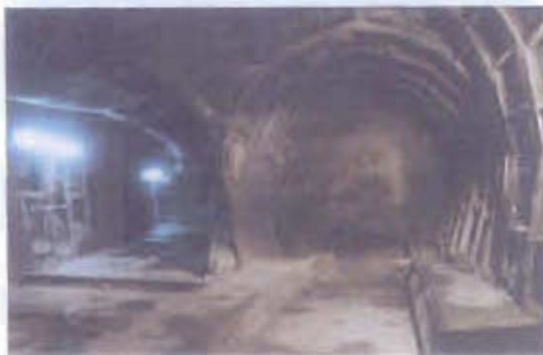
Encuentro de dos líneas, derivación 4 y derivación 3
