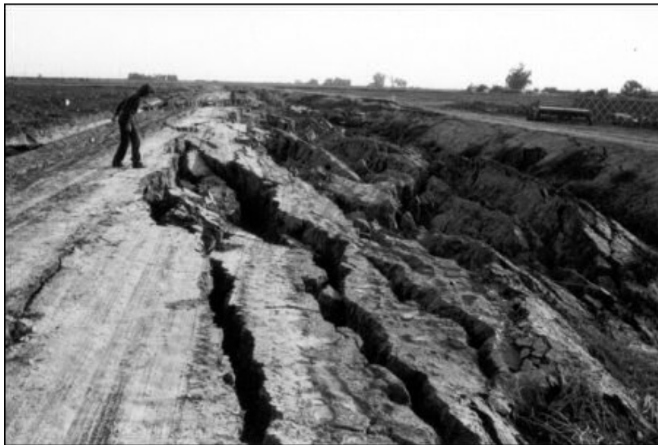
Figura 5.1 Daños ocasionados a un camino de tierra en California inducidos por el sismo Imperial Valley
