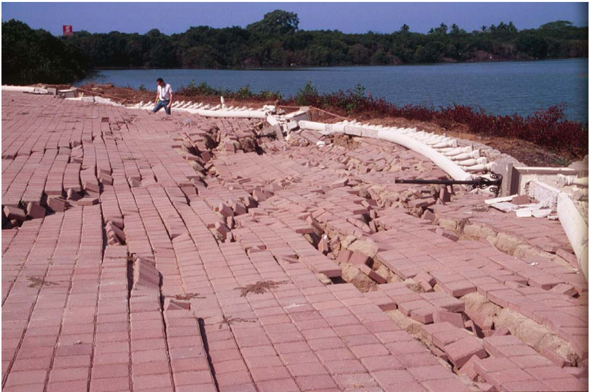
Figura 1.9 Desplazamientos laterales en las costas de Colima (sismo de Manzanillo, 1995)
