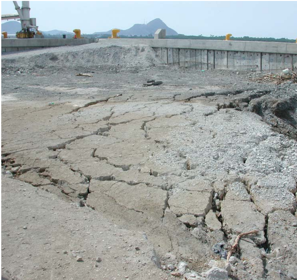
Figura 1.9 Desplazamientos laterales en las costas de Colima (sismo de Manzanillo, 1995)
