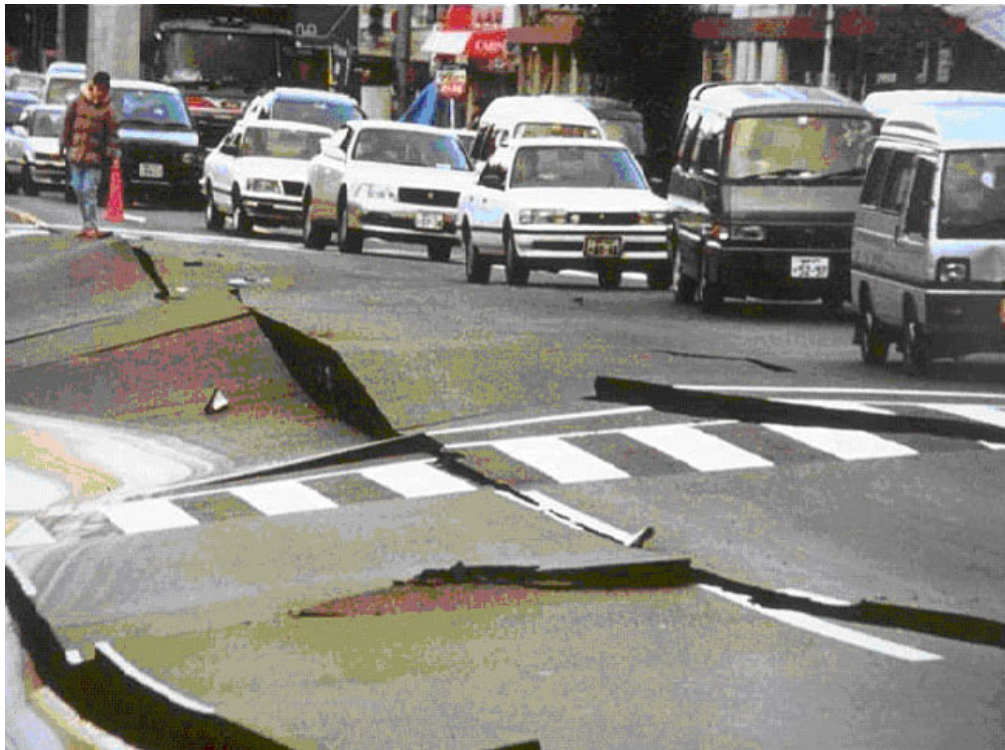
Figura 1.6 Fracturas del pavimento ocasionadas por licuación (sismo de Kobe en Japón, 1995)
