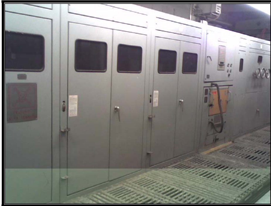
Fig. 2.15. Subestación de media tensión 23 kV
