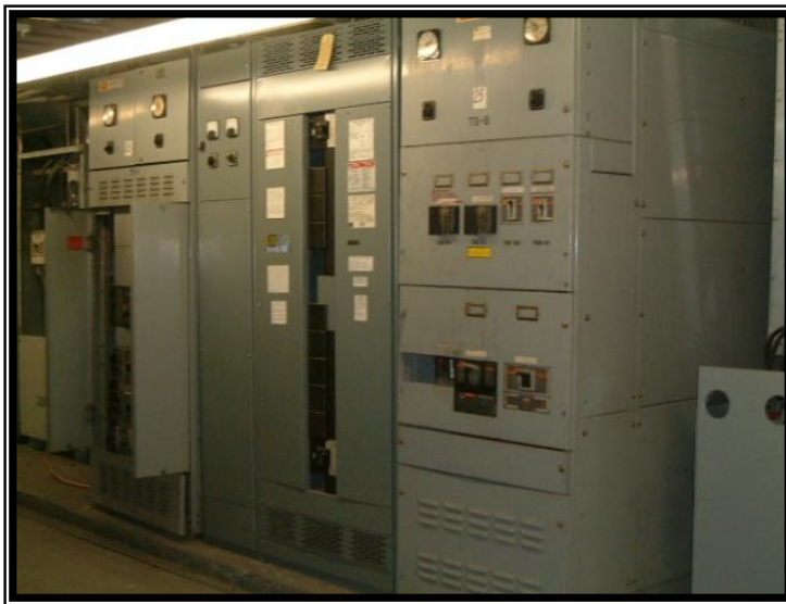
Fig. 3.3. Tablero autoportado en baja tensión que será removido para su reemplazo.
