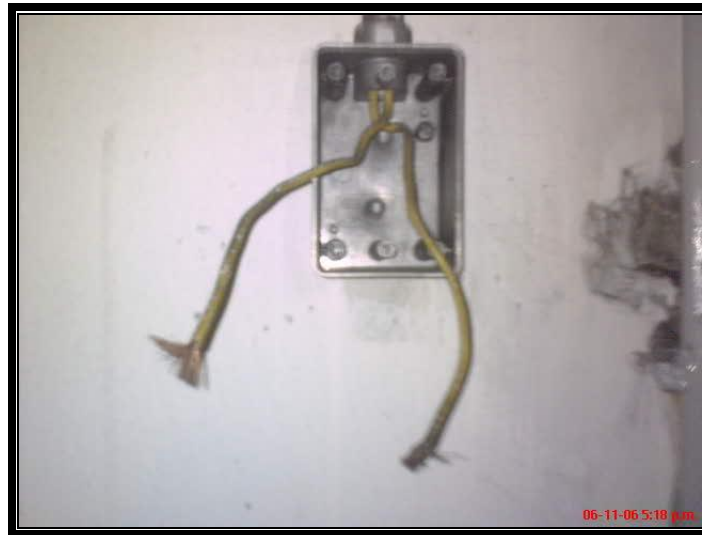
Fig. 2.7 Dentro de la subestación Internacional Planta Baja existen contactos que no están en buen estado, siendo un peligro para los usuarios, por lo que es necesario su cambio.
