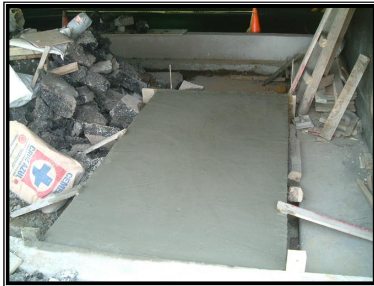
Fig. 3.2 Base de concreto para la ubicación de planta de emergencia
