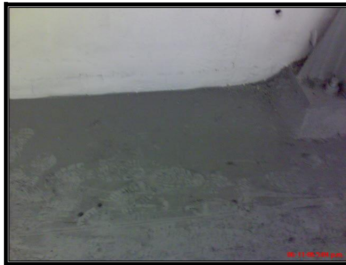
Fig. 2.10 Dentro de la subestación Internacional Planta Baja existe mucho polvo, por lo que se requiere un mantenimiento periódico de limpieza.
