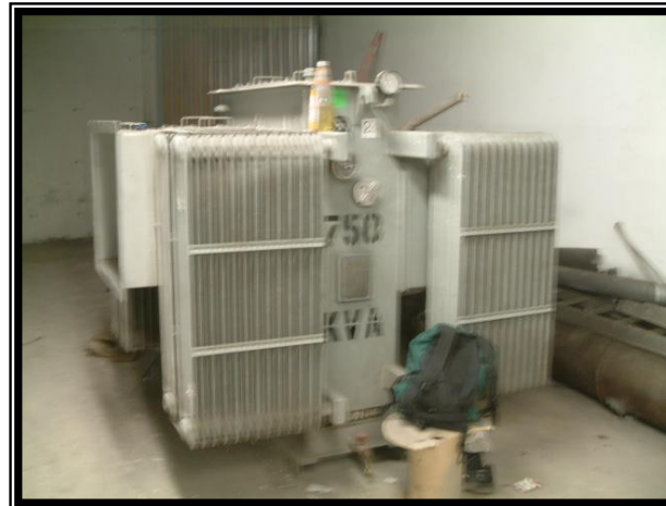
Fig. 2.3 Transformador "2" removido por falta de carga.
