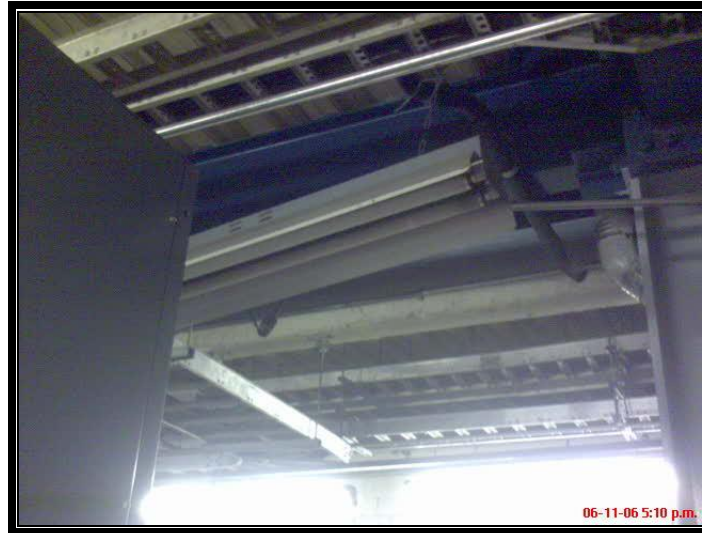
Fig. 2.9 Dentro del local de la subestación existen lámparas en mal estado, algunas rotas, deformadas, e incluso inservibles por lo que se requiere su reemplazo.
