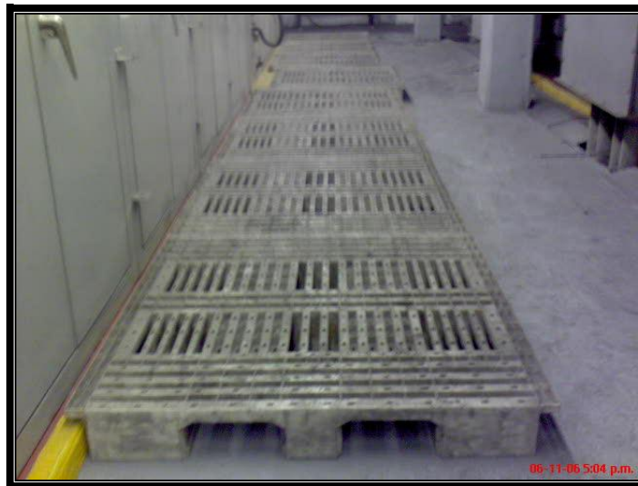
Fig. 2.12 En el área de alta tensión, las tarimas que existen no son las correctas por lo que se requiere que se cambien por las que se apegan a la norma NOM-001-SEDE-2005.
