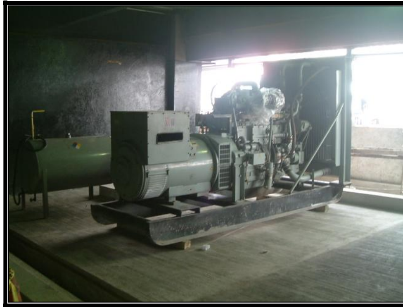
Fig. 2.17. Planta de emergencia G1
