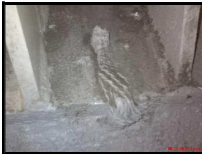
Fig. 2.8 Dentro de la subestación Internacional Planta Baja, la tierra está conectada a las columnas como se puede observar en la fotografía.
