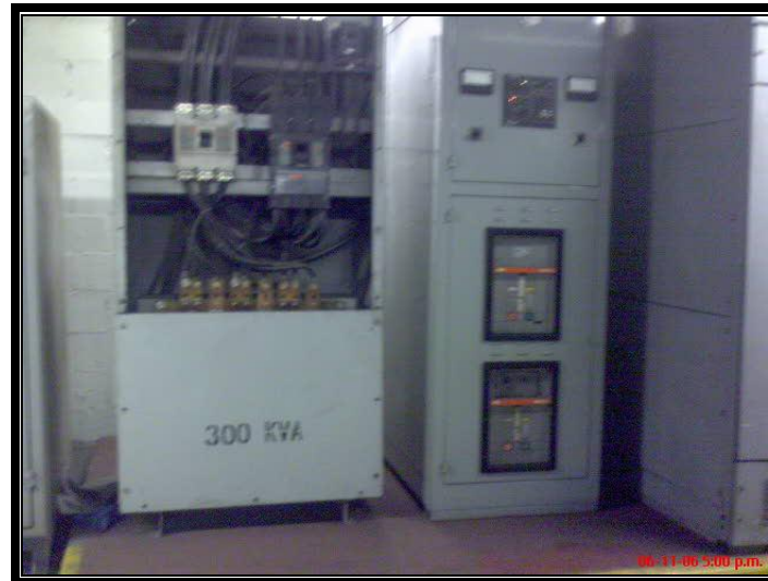
Fig. 2.13 Existen tableros sin tapa como el que se observa en la fotografía, donde se puede tener contacto con las partes vivas fácilmente.
