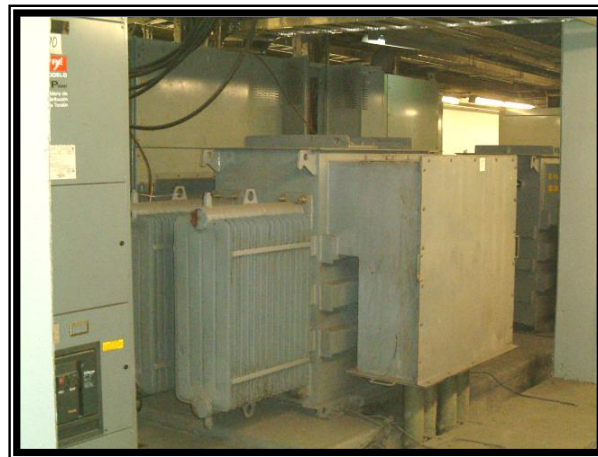
Fig. 2.4 Transformadores de la Subestación Internacional
