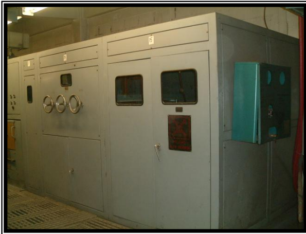
Fig. 2.1 Gabinete de acometida
