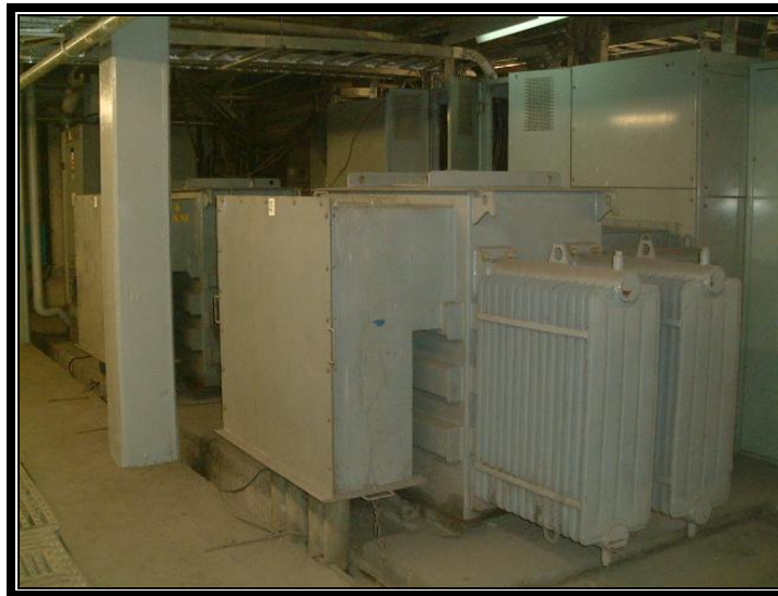
Fig. 2.16. Transformador 23 kV- 440 V / 254 V 1000 kVA
