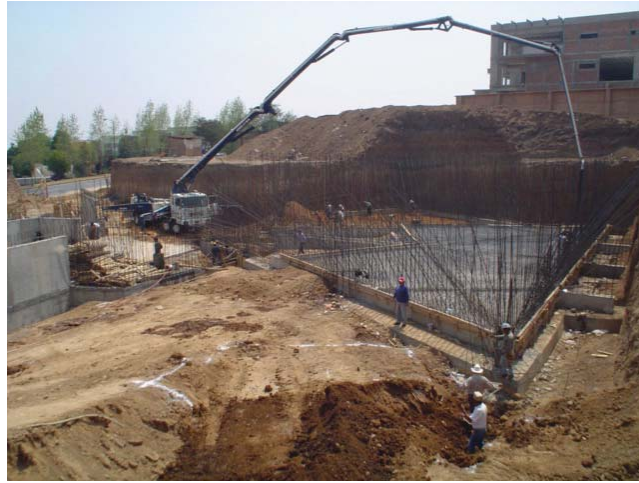
Colado de zapatas corridas de cimentación y losa de desplante para comenzar el armado de la estructura de acero. (25-05-05)
