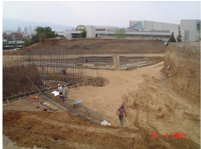
Se comenzaron con los trabajos de cimentación a base de zapatas corridas asentadas en el terreno natural sobre una plantilla de concreto de 5 cm. (14-04-05)
