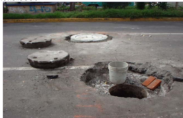
SISTEMA DE DRENAJE
