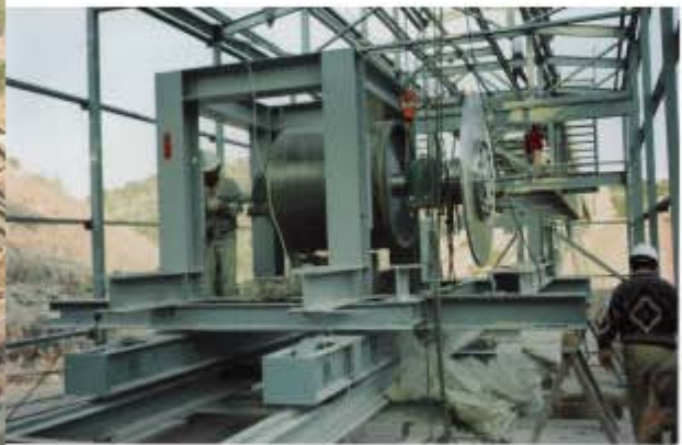
En estas fotos vemos la estructura de la zona de las canteras y la inferior parte de la transmisión
