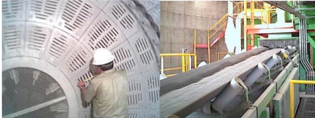
Detalle del diafragma intermedio del molino de agregados y de la banda de alimentación del molino
