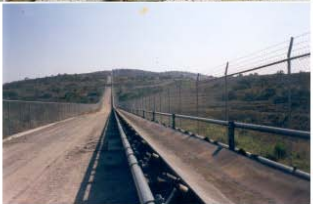
En estas fotografías vemos el avance de los trabajos y montajes de túneles y estructuras en partes difíciles por el terreno y por pasar sobre las vías del ferrocarril, al final ya está lista para ponerla a funcionar
