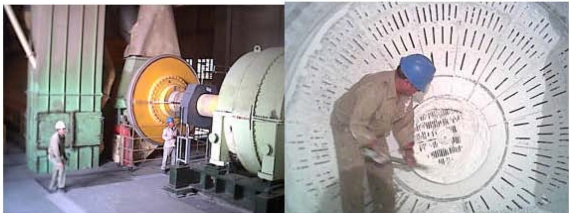
Detalles de las instalaciones de los sistemas de inyección de agua a los molinos N0 6 de cemento y el interior del Unidan de cemento blanco
