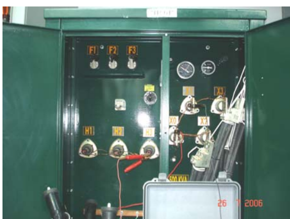
Figura 39. TRANSFORMADOR TIPO PEDESTAL
