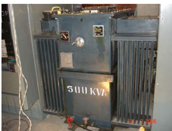
Figura 41. TRANSFORMADOR TIPO SUBESTACIÓN
