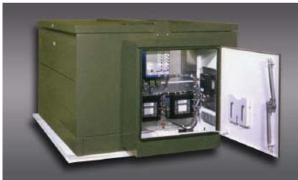
FIGURA 9. SECCIONADOR DE TRANSFERENCIA AUTOMÁTICA TIPO PEDESTAL
