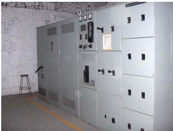
Figura 47. SUBESTACIÓN COMPACTA SERVICIO INTERIOR
