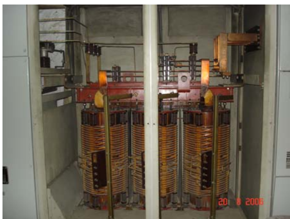
Figura 38. TRANSFORMADOR TIPO SUBESTACIÓN EN AIRE
