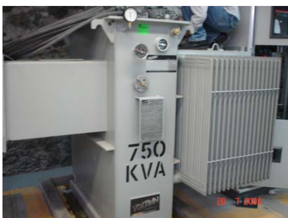
Figura 42. TRANSFORMADOR TIPO SUBESTACIÓN
