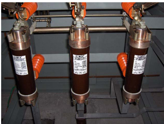
Figura 45. PORTA FUSIBLES Y FUSIBLES
