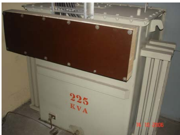
Figura 40. TRANSFORMADOR TIPO SUBESTACIÓN
