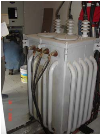
Figura 43. TRANSFORMADOR TIPO SUBESTACIÓN
