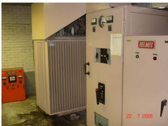
Figura 37. TRANSFORMADOR TIPO POZO
