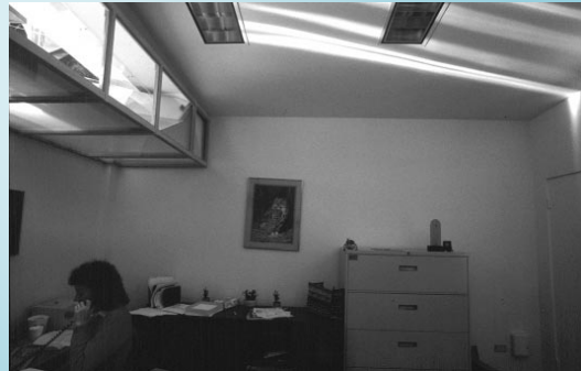
Figura 3.6: Lado sur de un sistema de luz natural ópticamente tratado, Palm Springs, California.
