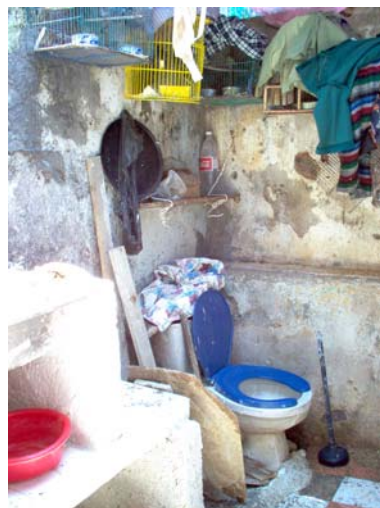
6.5.2.36 Sanitario de una vivienda. Barrio de San Francisquito. Año 2005.
